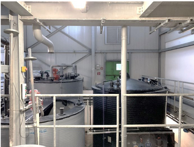
Pilotanlage Stuttgarter Verfahren. Quelle: FHNW
