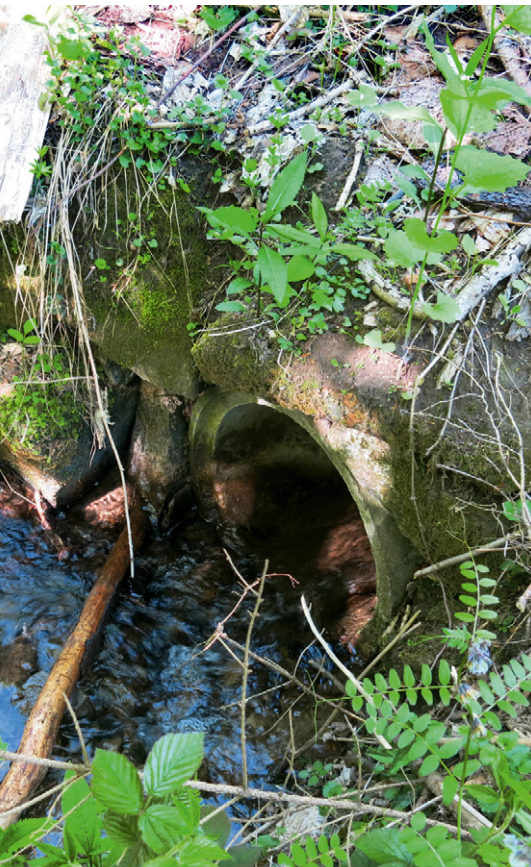
Abb. 7: Zu schmale Verrohrungen ohne Substratauflage an Quellen und Bächen vor der Maßnahmenumsetzung. Foto: Robert Behnke
