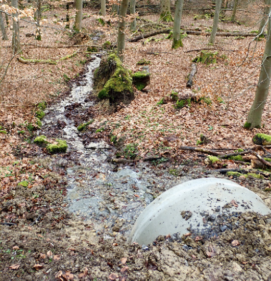
Abb. 11: Größere Verrohrungen (100–120 cm Durchmesser) und Rahmenprofile mit Substratauflage wurden eingebaut. Foto: Robert Behnke
