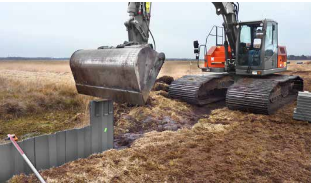
Abb. 3: Die Wiedervernässung von Mooren, beispielsweise durch den Einbau von Spundwänden wie hier im Oppenweher Moor (Kreis Minden-Lübbecke), ist eine wesentliche Maßnahme im Moorschutz. Foto: Thorsten Obracay
