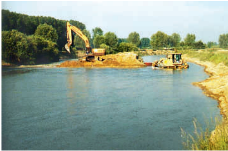
Entfesselung, Verbreiterung und Aufhöhung der Sohle: Umbau der Lippe in der Klostermersch in 1997
