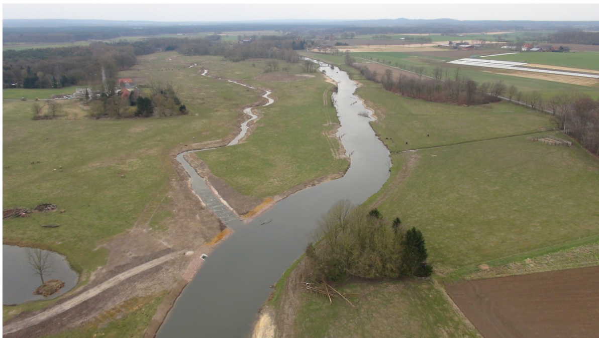
Abb. 13: Umgehungsgerinne (im Bau befindlich) an einem sandgeprägten Tieflandfluss; oben: zu erhaltendes Querbauwerk (linker Bildrand) und Wiedereinmündung des Umgehungsgerinnes im Unterwasser (Blick gegen Fließrichtung); unten (Blick mit der Fließrichtung): Ausleitungsstelle des Umgehungsgerinnes sowie ausgedehnter Rückstaubereich im Oberwasser (Fotos: PBK)
