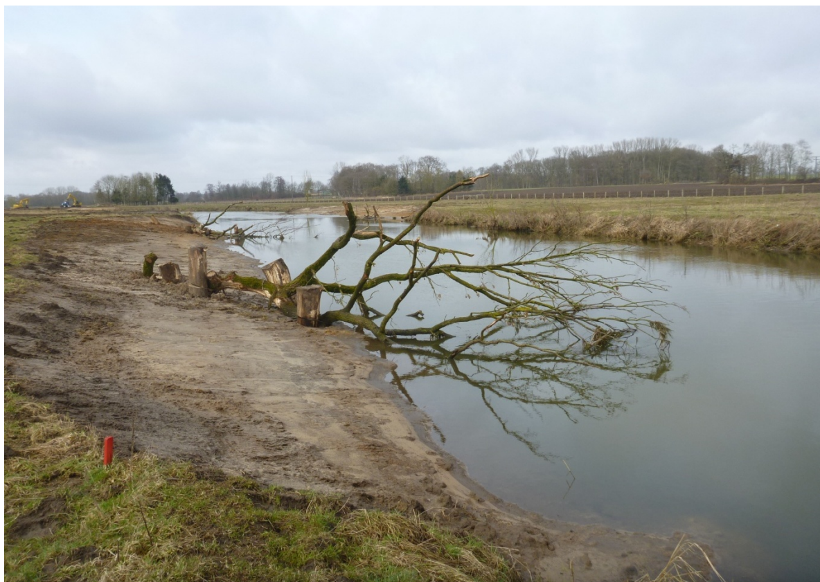
Abb. 15: Maßnahmen zur Optimierung eines ausgedehnten Rückstaubereichs an einem sandgeprägten Tieflandfluss: Anlage von Nebenrinnen, Profilaufweitungen und Totholzeinbau (Fotos: PBK)
