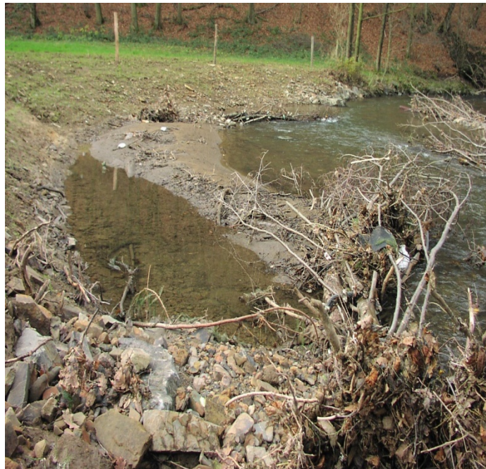
Abb. 19: Einbau von gesichertem Totholz zur Erhöhung der Dynamik und Sedimentmobilisierung an einem großen Talauenbach im Deckgebirge (Foto: PBK)
