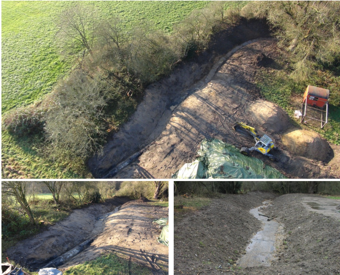
Abb. 4: Rückbau einer Verrohrung an einem sandgeprägten Bach der Sander und sandigen Aufschüttungen: oben: Multikopteraufnahme während der Freilegung; unten links: während der Bauphase – Teile der Verrohrung sind noch sichtbar; unten rechts: nach Abschluss der Bauphase freigelegter Bach (Fotos: PBK, Blick in Fließrichtung)
