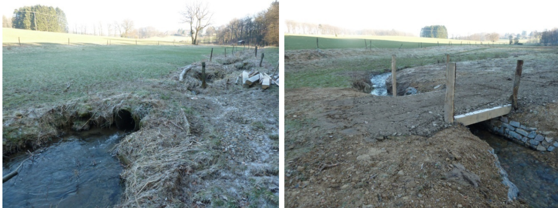
Abb. 9: Ersatzneubau eines sohldurchgängigen Durchlasses/Brücke an einem kleinen Talauebach des Grundgebirges (Eifgenbach) (Fotos: Wupperverband)
