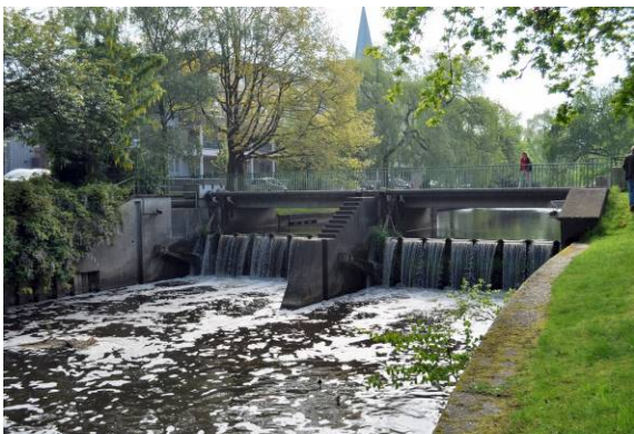
bewegliches Wehr 0,3 – 1 m
