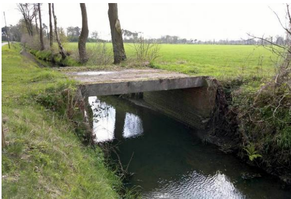
Brücke, unverbautes Ufer unterbrochen, mit Sediment
