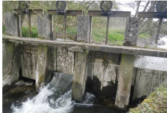
bewegliches Wehr 0,3 – 1 m
