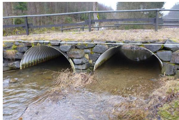
Durchlass, Lauf verengt, mit Sediment
