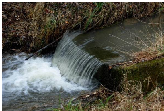
mittlerer Absturz 0,3 – 1 m
