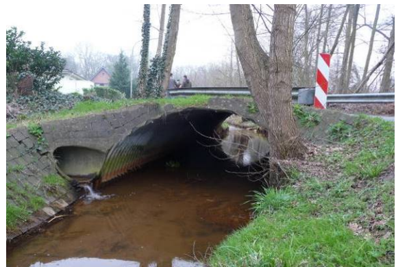
Durchlass, unverbautes Ufer unterbrochen, mit Sediment
