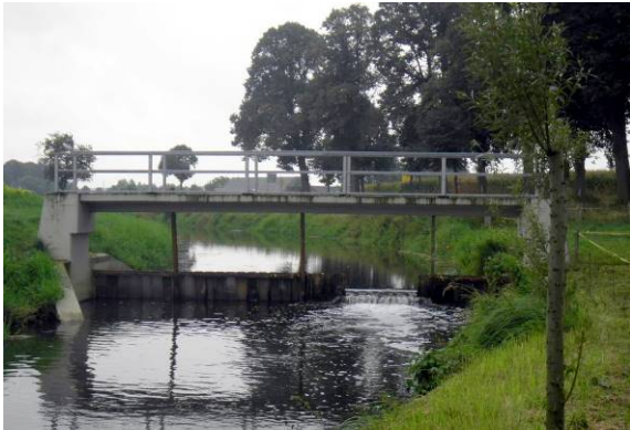
bewegliches Wehr 0,3 – 1 m
