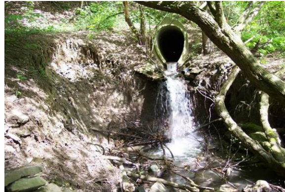
hoher Absturz > 1 m
