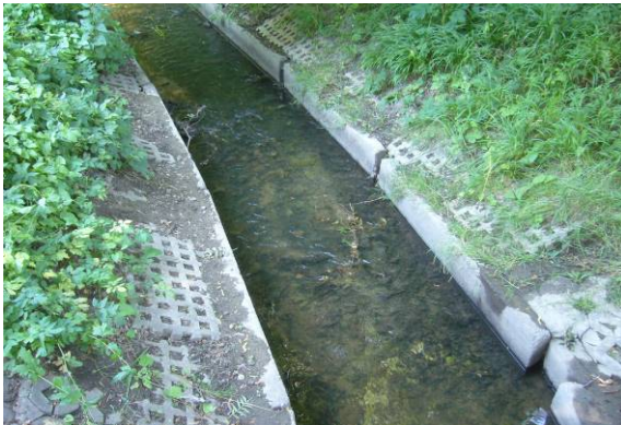
Massivsohle mit Sediment
