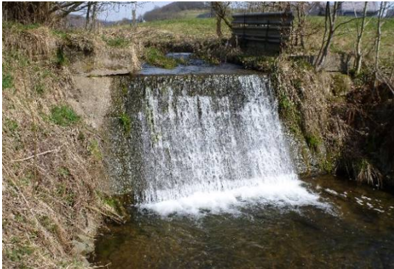
hoher Absturz > 1 m
