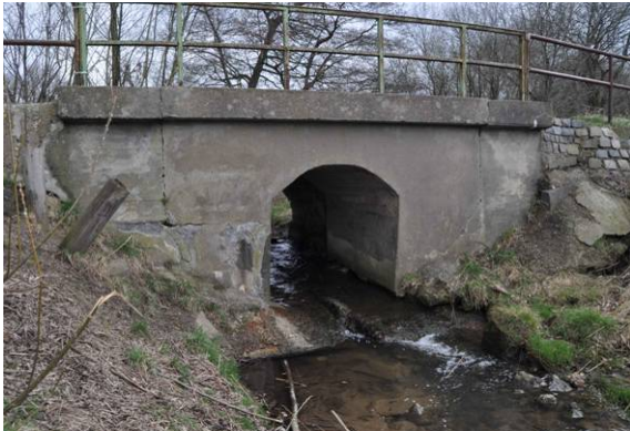
Brücke, Lauf verengt, ohne Sediment
