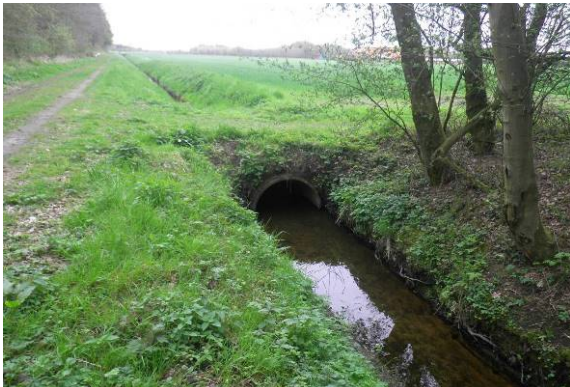
Durchlass, unverbautes Ufer unterbrochen, mit Sediment
