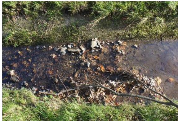
Massivsohle mit Sediment
