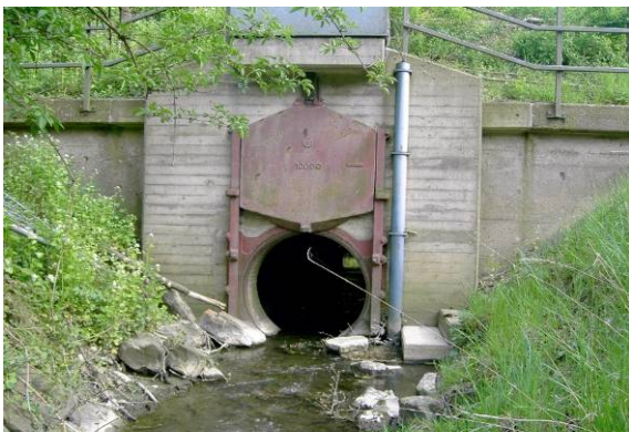
Durchlass, Lauf verengt, mit Sediment (Durchfluss durch den Erdkörper eines HRB)
