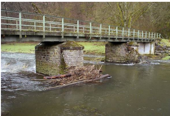
Brücke, Lauf verengt, mit Sediment
