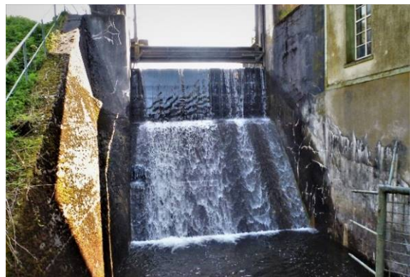
bewegliches Wehr > 1 m
