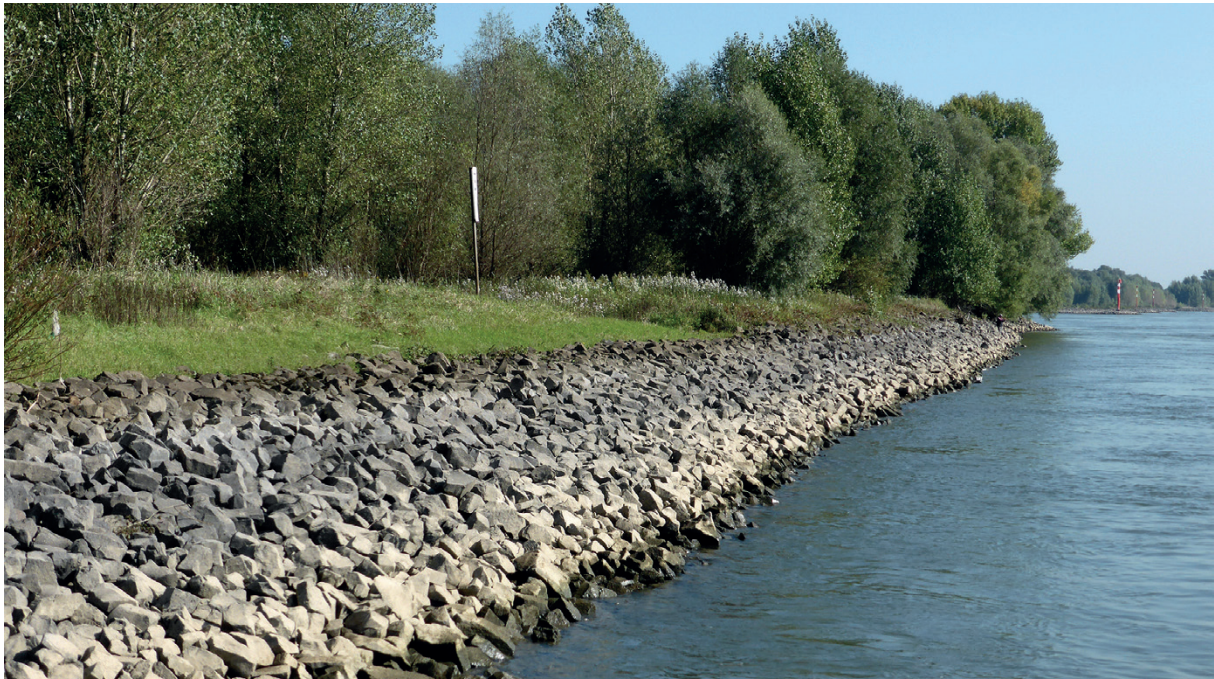
Abb. 6: Blocksteinschüttungen sind häufig an Abschnitten mit starker Strömung und an Prallhängen anzutreffen
