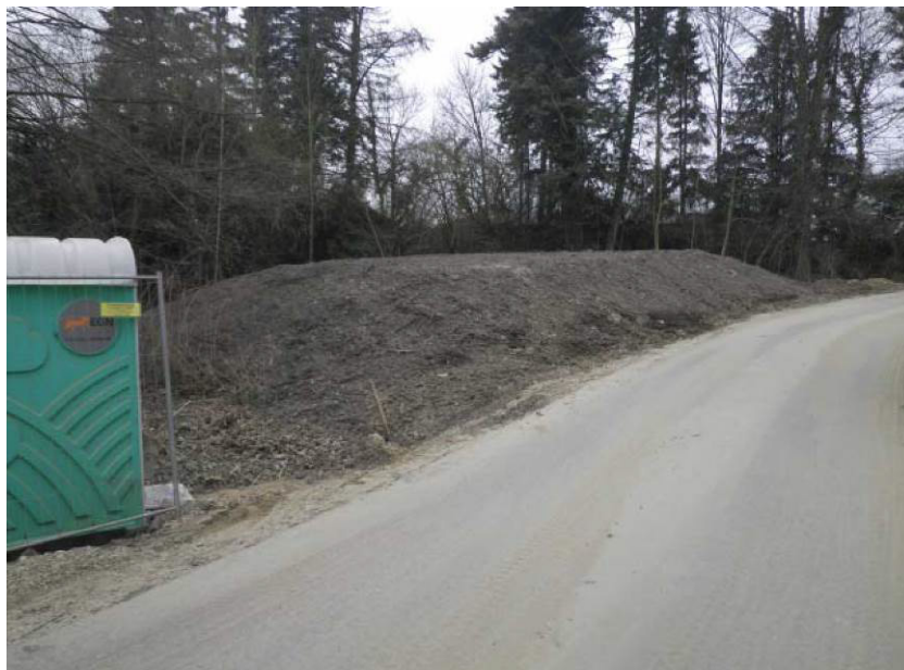
April 2013: Blick auf die Oberbodenmiete von der Zufahrt aus. Begrünung noch ausstehend.
