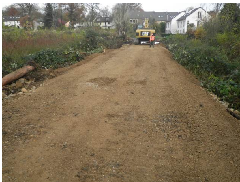
November 2012: Anlegen der Baustraße; fehlende Abgrenzung zum anstehenden Boden wurde bemängelt und führte zu erhöhtem Aufwand beim Rückbau der Baustraße.
