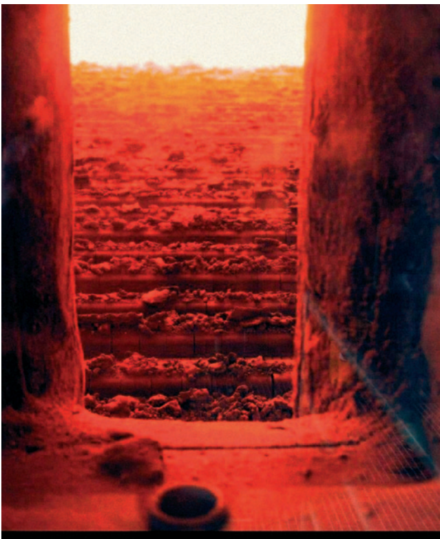
Ausbrand und Kesselasche (Quelle: EnBW Biomasse GmbH)
