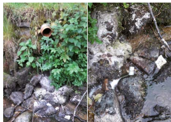
Direkteinleitung häuslichen Abwassers mit Resten von Toilettenpapier sowie weiterer Hygieneartikel oberhalb der Teichanlage (Albaumer Bach)
