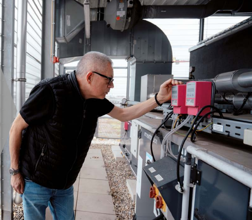
Auf dem Dach des Dienstgebäudes in Duisburg prüft Werner Schlösser vom Fachbereich „Innerer Dienst“ die moderne Lüftungsanlage
