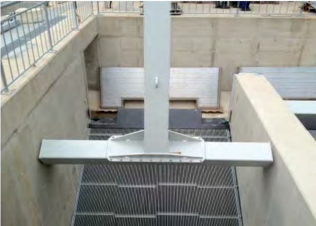
Rechen in der WKA Unkelmühle
