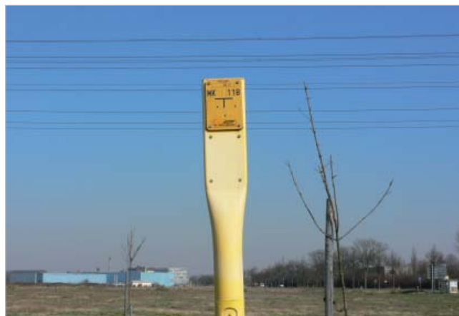
Gasfernleitung in der Nähe einer Industrieanlage
