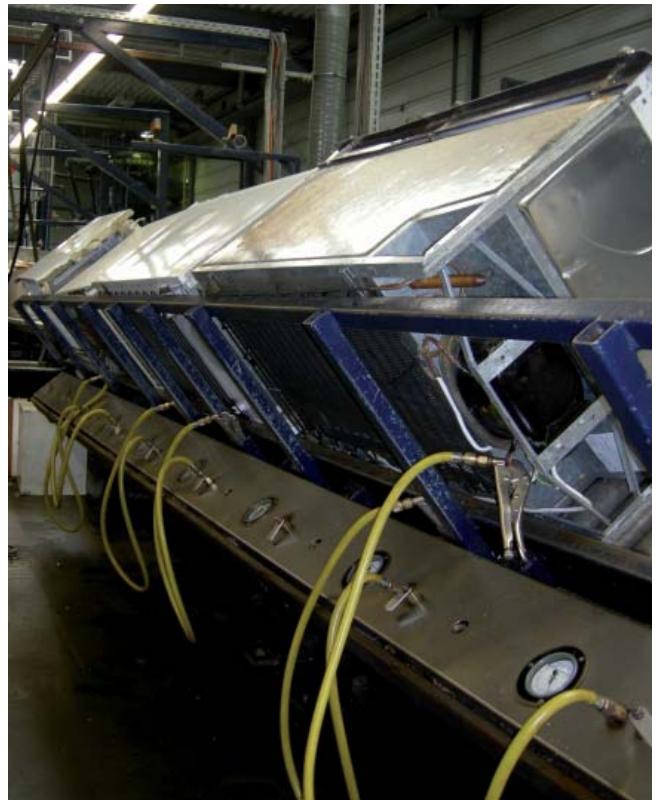
Kühlgeräte in einer Entsorgungsanlage
