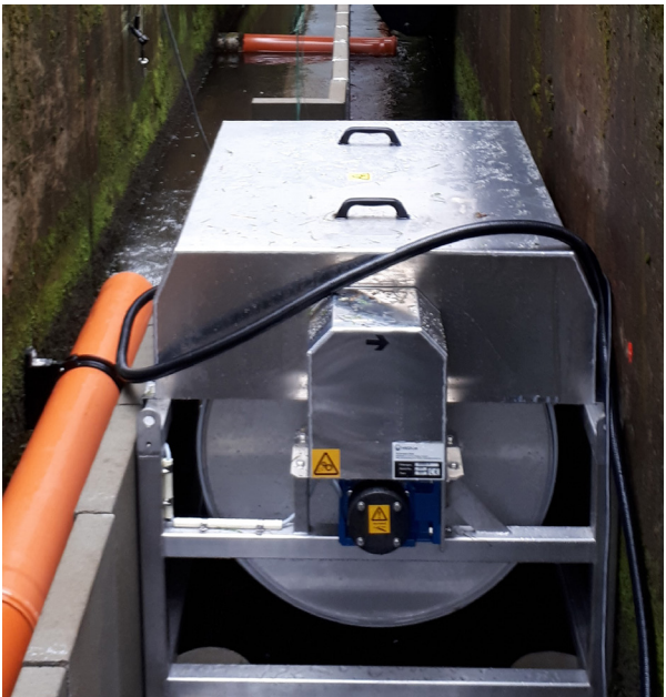
Trommelfilter im Ablaufgraben einer Fischzucht
