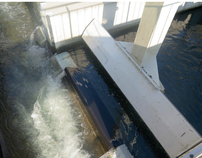
Der Fischweg an der Wasserkraftanlage Unkelmühle (Sieg) hat alles, was ein Lachs-Smolt braucht: Oberflächenbypass mit Zehnmillimeter-Schutzrechen
