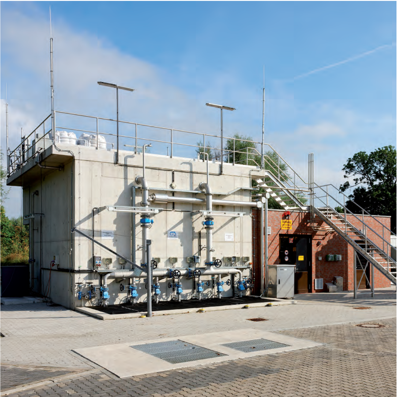
Kläranlage Duisburg-Vierlinden – Ozonung
