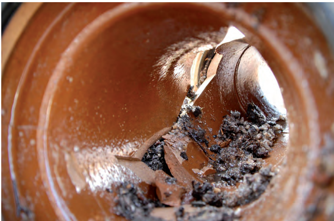
Abwasserrohre müssen funktionstüchtig sein
