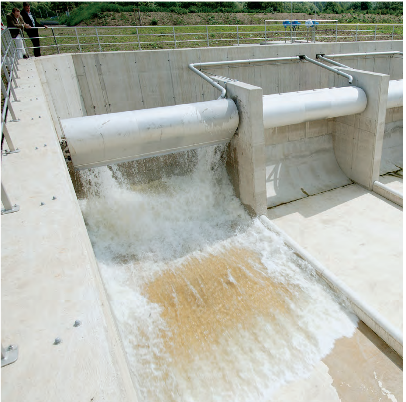
Funktionsprüfung an einem Regenüberlaufbecken
