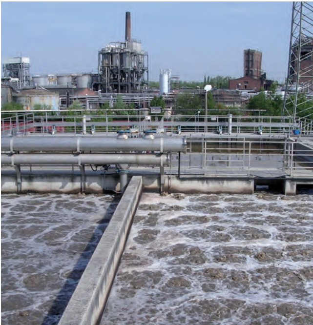
Vorbehandlungsanlage (Festbettbiologie) eines Industriebetriebes in in Castrop-Rauxel
