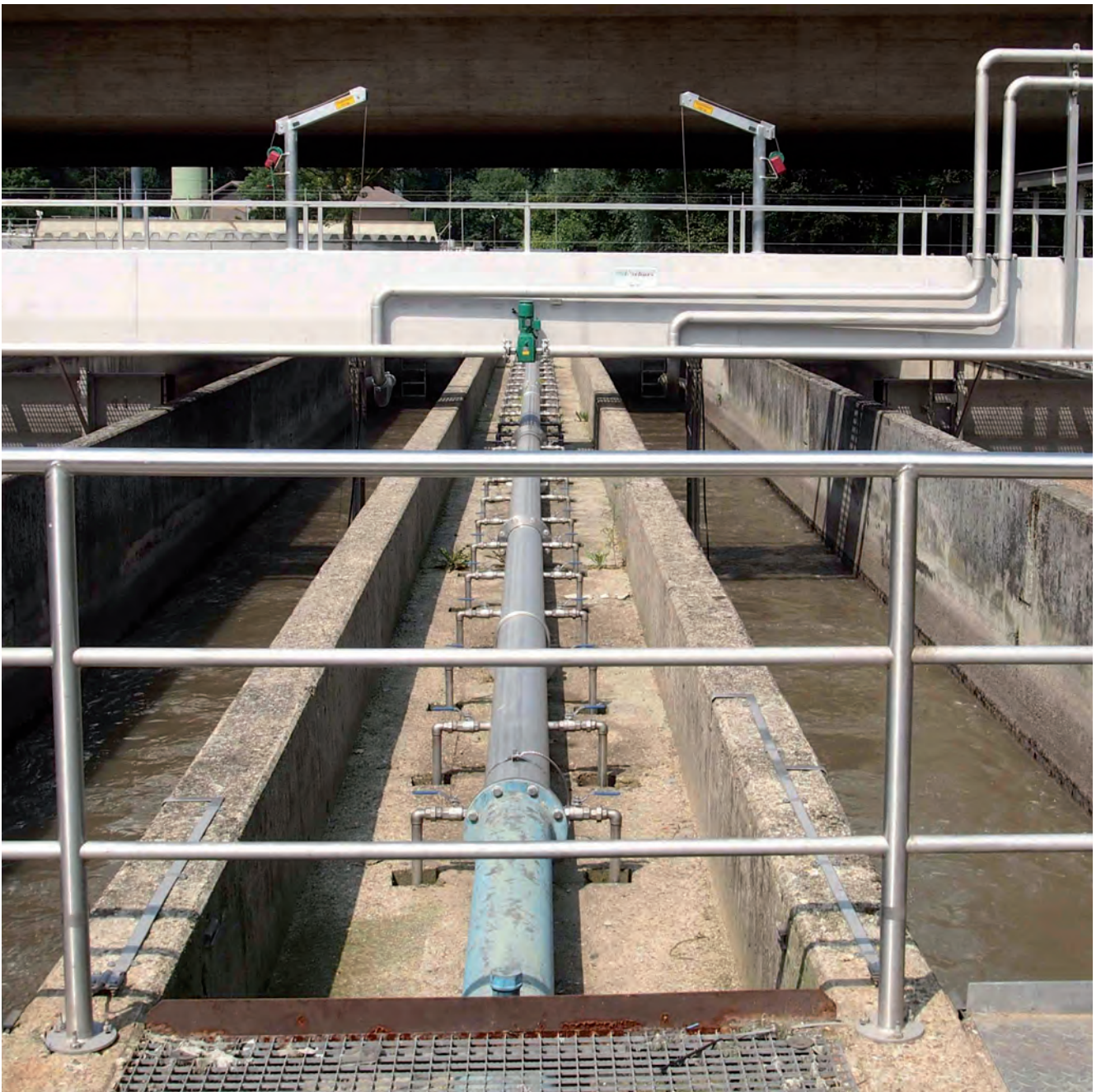
Sand- und Fettfang der Kläranlage Aachen-Soers
