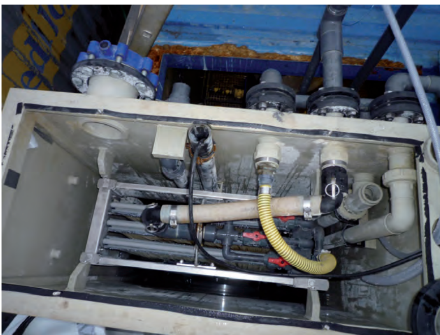
Membranmodul – Kläranlage Neuss-Ost
