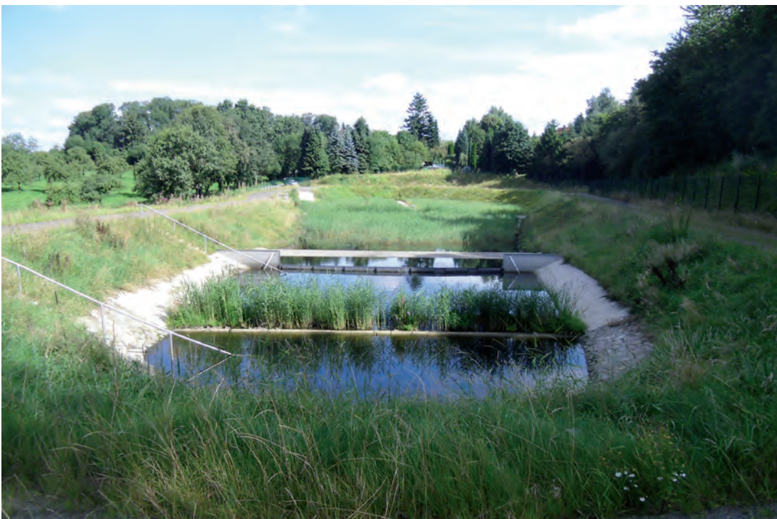
Retentionsbodenfilter zur Niederschlagsentwässerung von Verkehrsflächen
