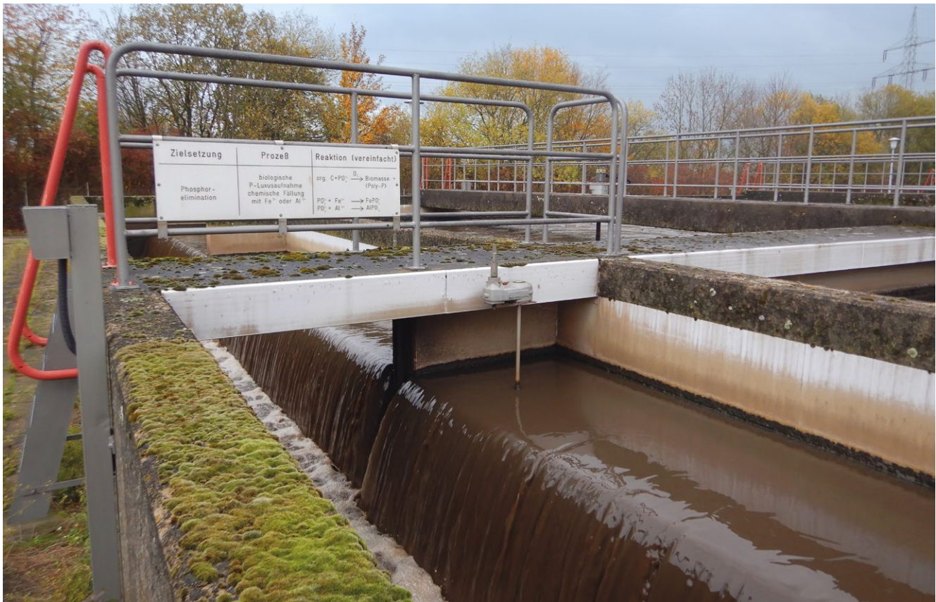
Biologische Phosphorelimination auf der Kläranlage Minden
