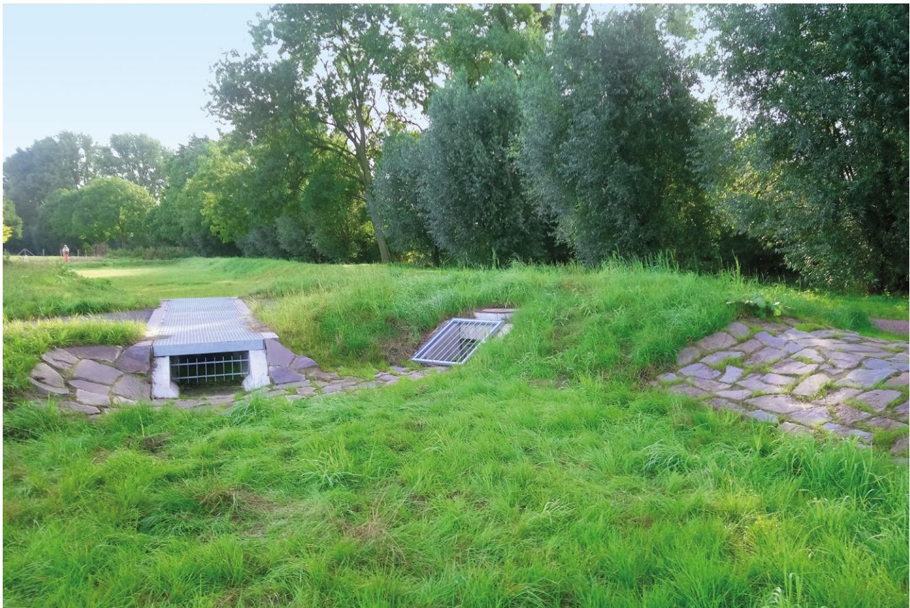
Zulauf zur Versickerungsmulde im Neubaugebiet Alter Angerbach in Duisburg
