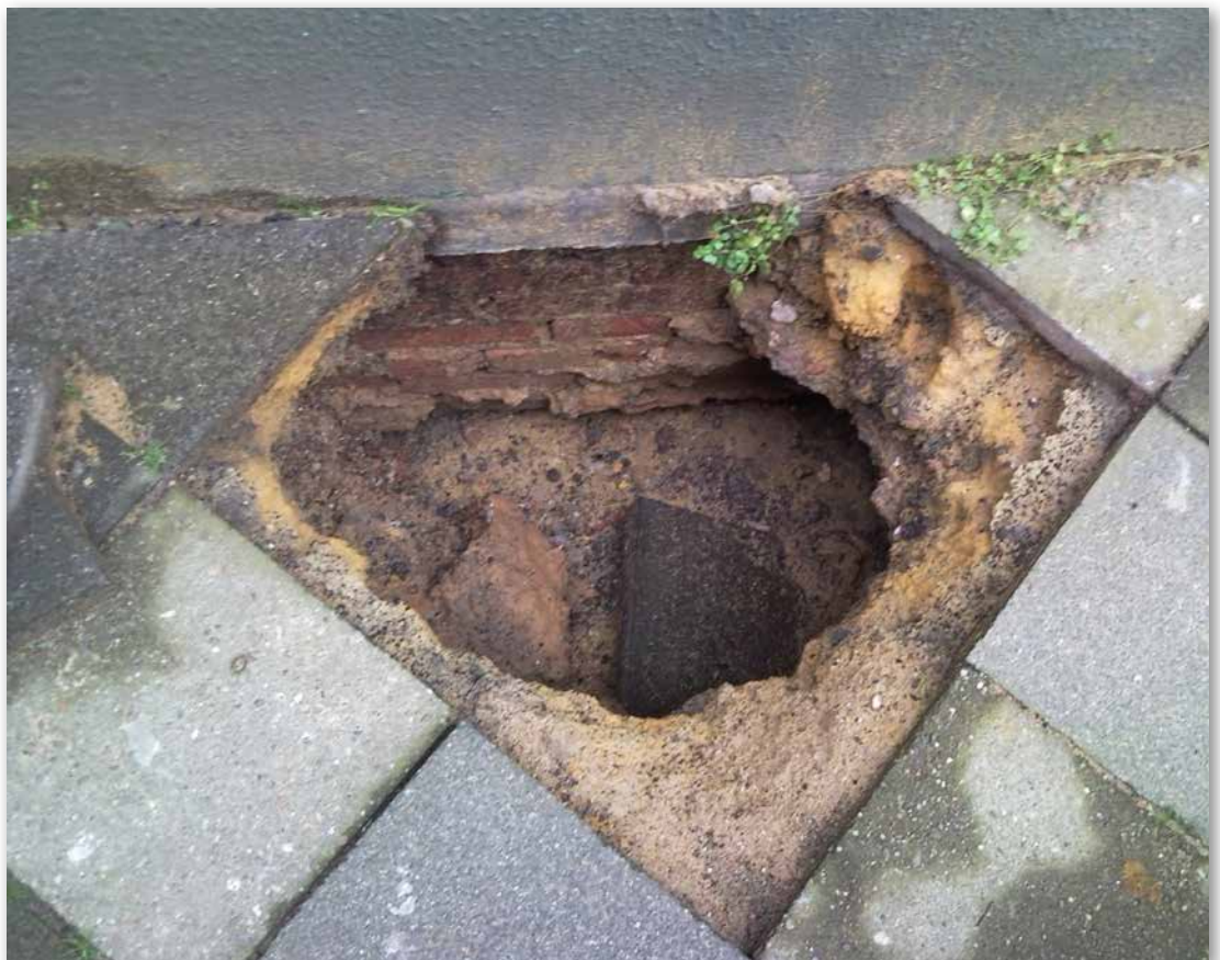
Bild 38: Straßeneinbruch im öffentlichen Verkehrsraum, Beispiel 13 [Foto: GELSENKANAL]
