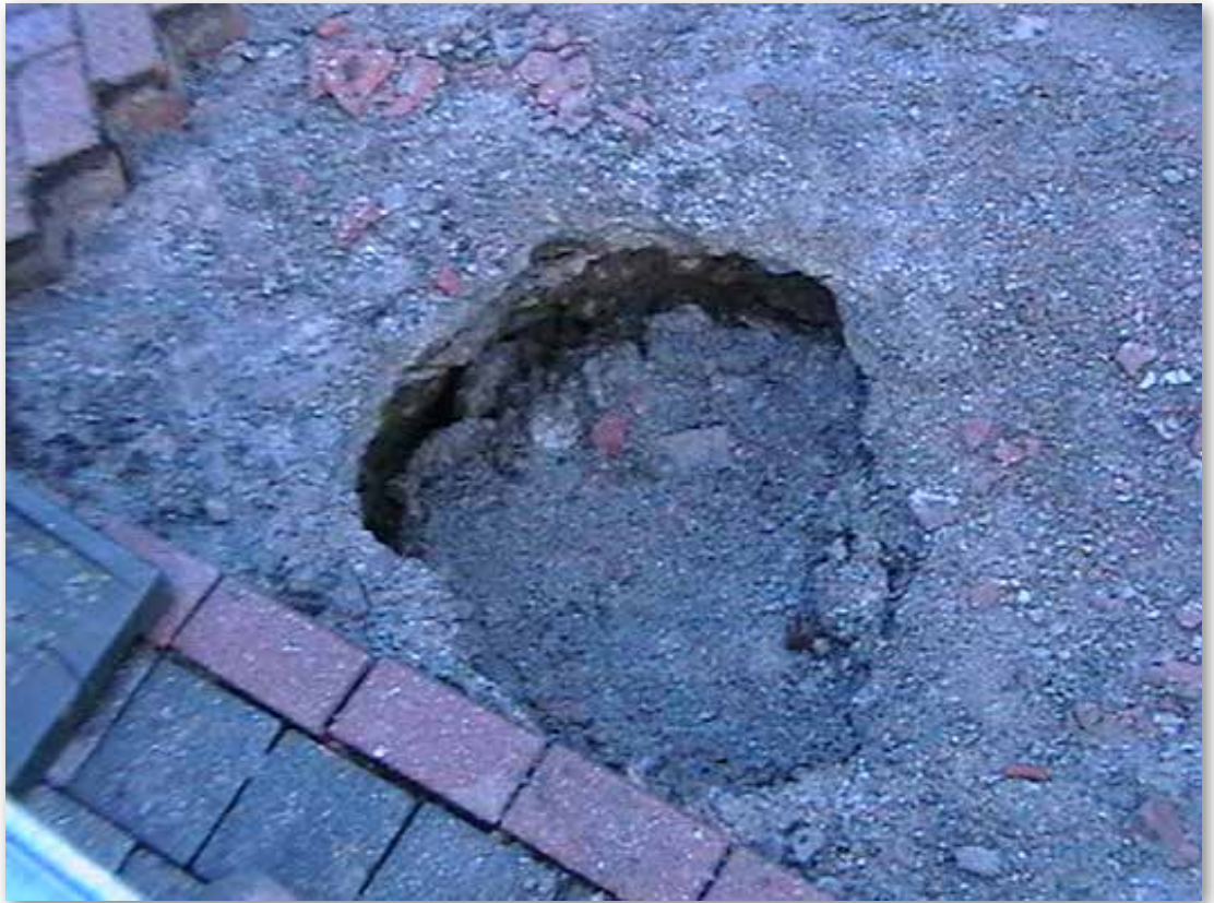
Bild 23: Absackung aus Bild 22 nach Aufnehmen des Pflasters [Foto: Technische Werke Emmerich am Rhein GmbH]
