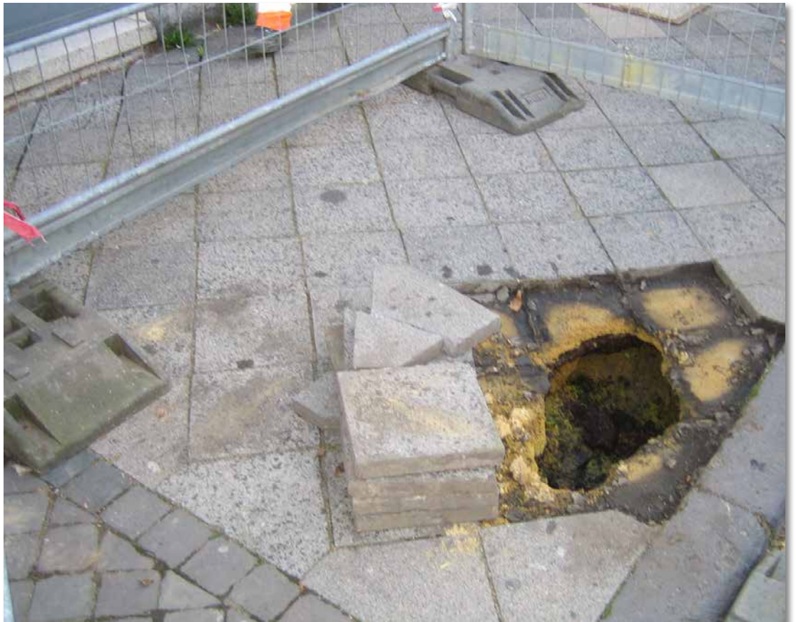
Bild 26: Straßeneinbruch im öffentlichen Verkehrsraum, Beispiel 2 [Foto: GELSENKANAL]
