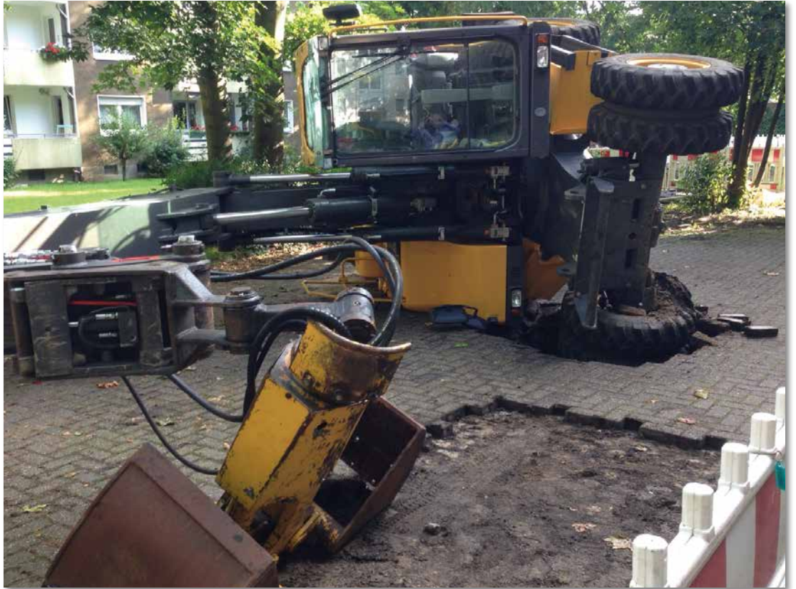
Bild 74: Umgestürzter Bagger infolge eines Tagesbruchs im öffentlichen Verkehrsraum, Ansicht 1 [Foto: Regh Holding GmbH]
