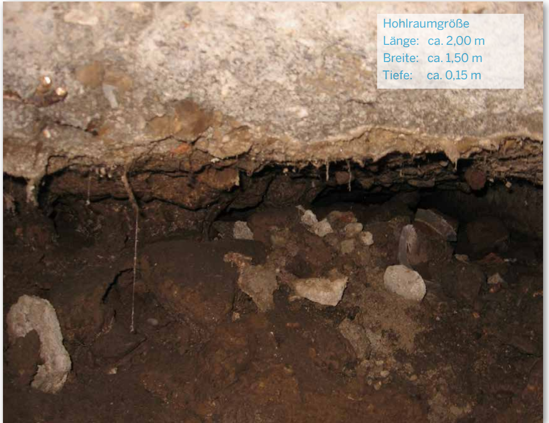
Bild 48: Detailansicht zu Bild 47, Hohlraum im Erdreich [Foto: Abwasser-Service Volkner GmbH]
