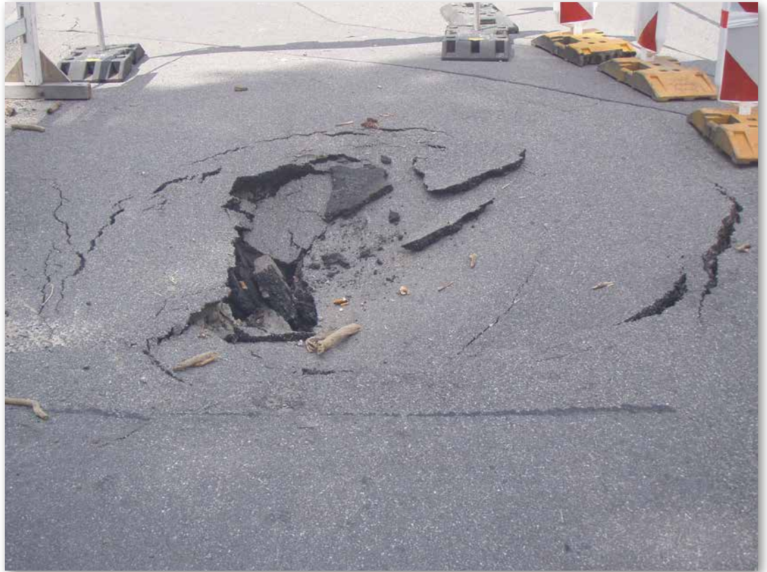
Bild 69: Absackung mit Straßeneinbruch im öffentlichen Verkehrsraum der Gemeinde Much [Foto: Ingenieurbüro Hartmann GmbH]
