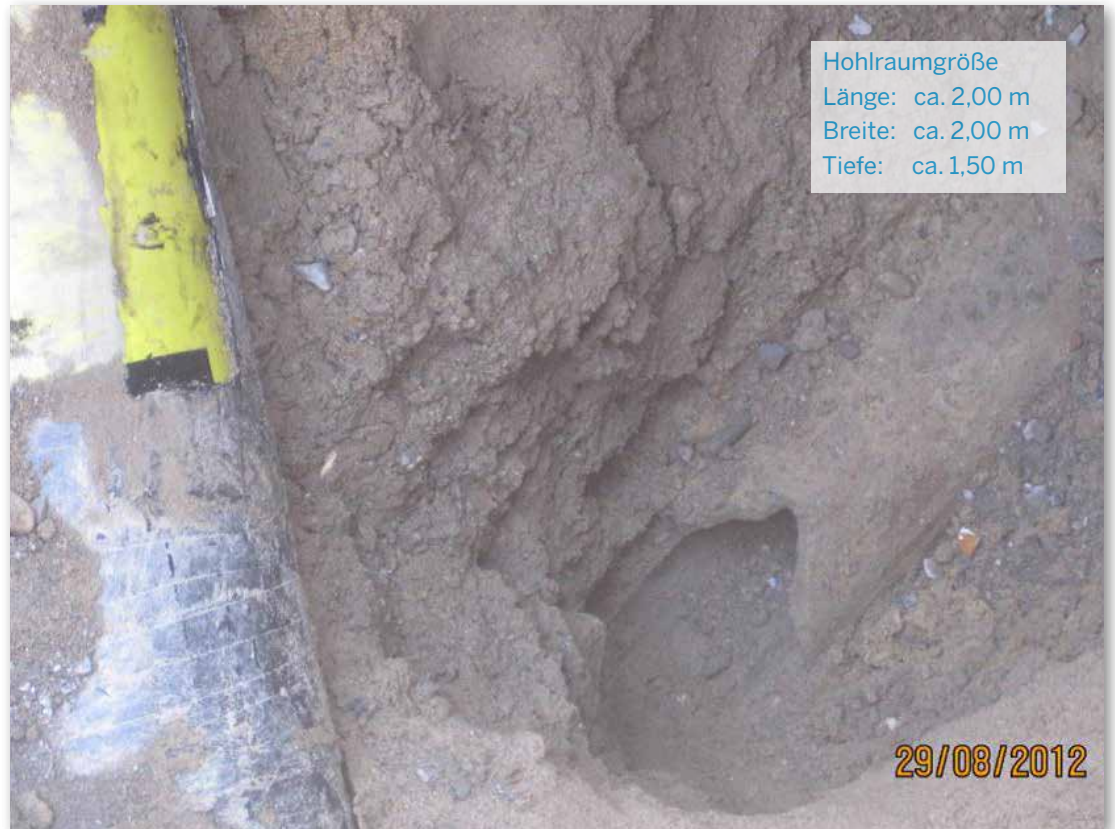
Bild 52: Freigelegter Hohlraum in der Kasparstraße, obere Rohrhälfte der Abwasserleitung in Teilbereichen nicht mehr vorhanden [Foto: Technische Betriebe Solingen]
