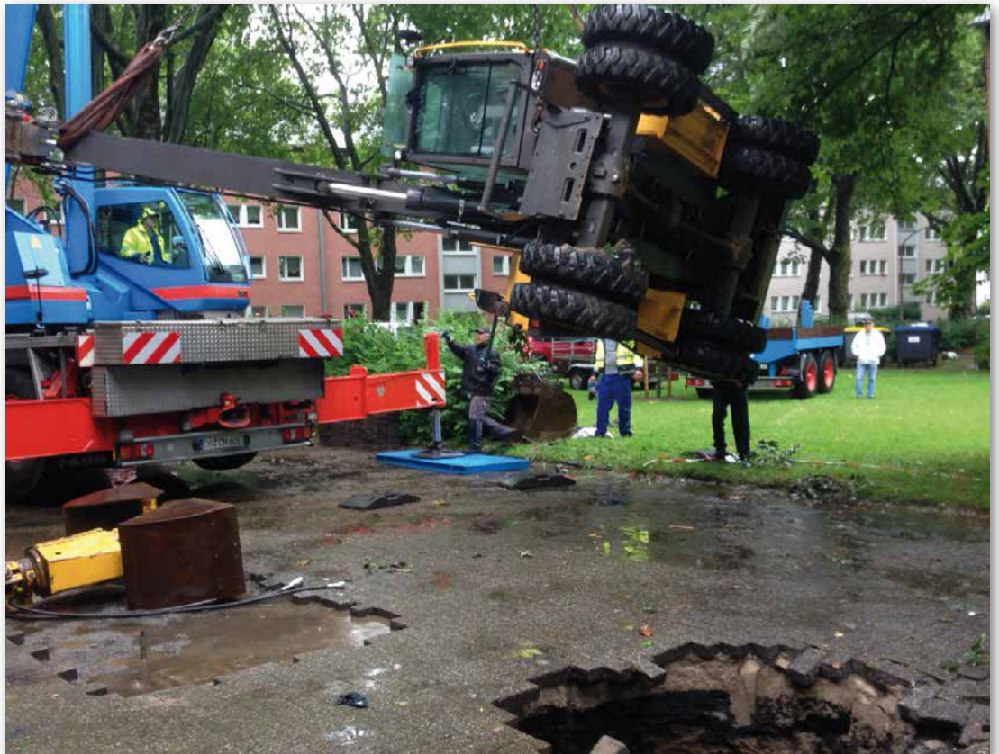
Bild 77: Bergung des Baggers mit einem Kran und Tagesbruch im öffentlichen Verkehrsraum [Foto: Regh Holding GmbH]
