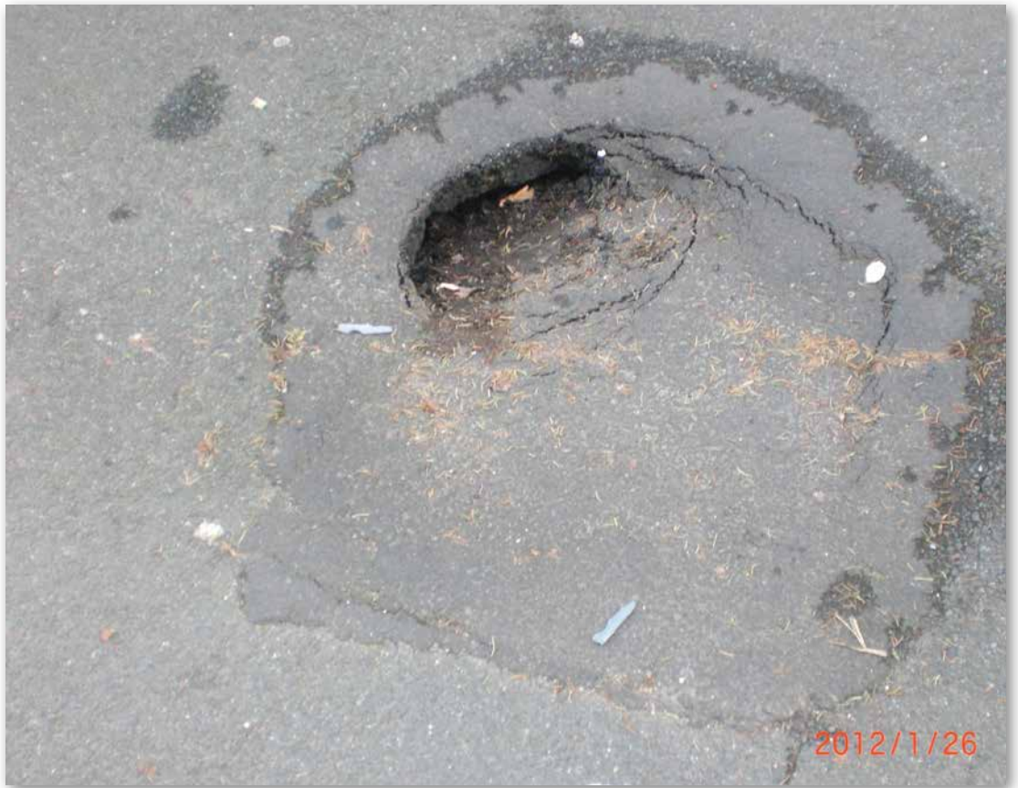
Bild 73: Straßeneinbruch in einer Privatstraße in Gelsenkirchen [Foto: Gelsenrohr Pluska]
