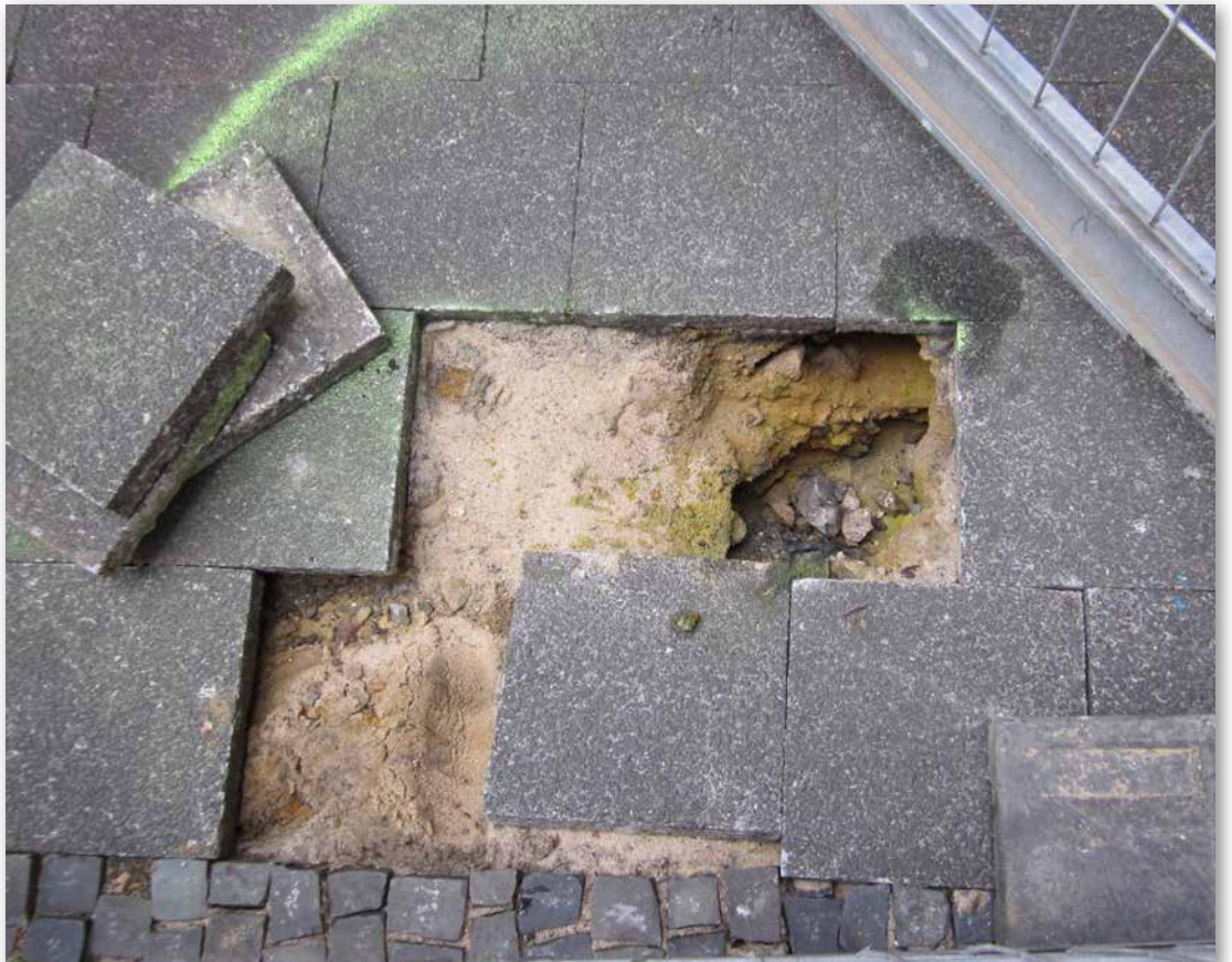
Bild 36: Straßeneinbruch im öffentlichen Verkehrsraum, Beispiel 11 [Foto: GELSENKANAL]
