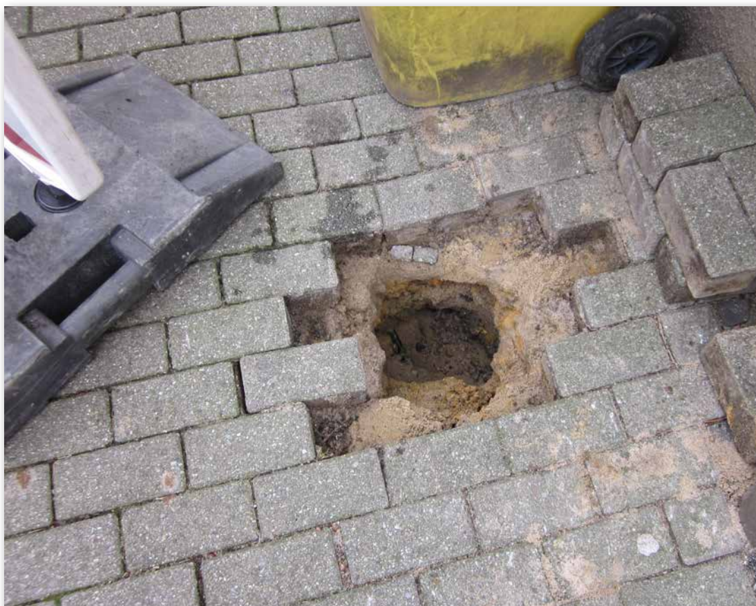
Bild 32: Straßeneinbruch im öffentlichen Verkehrsraum, Beispiel 7 [Foto: GELSENKANAL]
