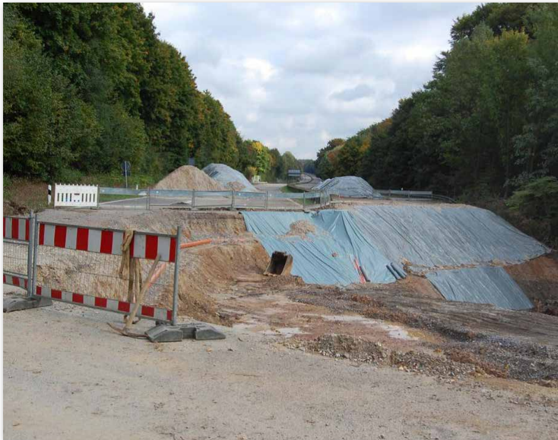
Bild 63: Ansicht der Baustelle auf der Viehbachtalstraße infolge des unterirdischen Hohlraums [Foto: Technische Betriebe Solingen]
