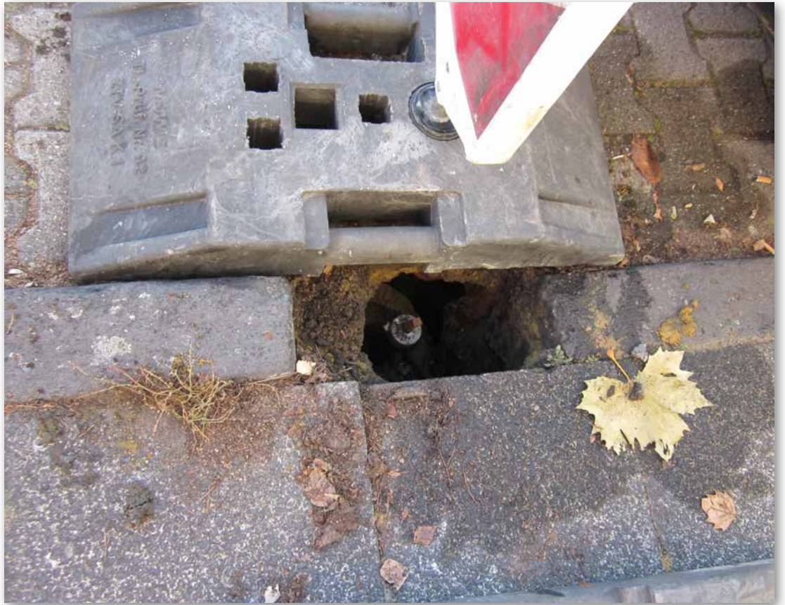
Bild 39: Straßeneinbruch im öffentlichen Verkehrsraum, Beispiel 14 [Foto: GELSENKANAL]
