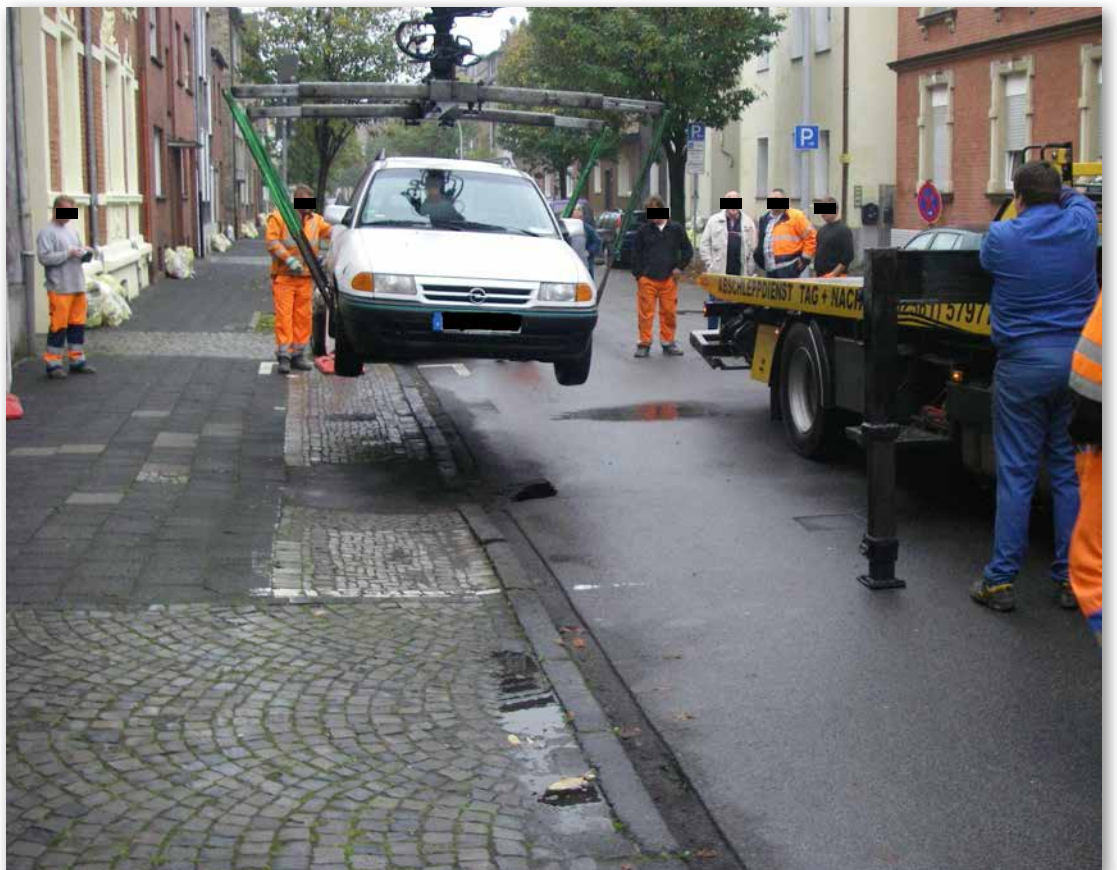
Bild 41: Straßeneinbruch im öffentlichen Verkehrsraum, Foto 2 [Foto: Stadt Hamm]
