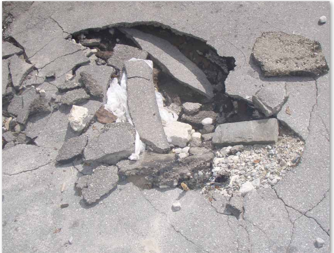
Bild 70: Straßeneinbruch im öffentlichen Verkehrsraum vor Schloss Neuschwanstein [Foto: Ingenieurbüro Hartmann GmbH]
