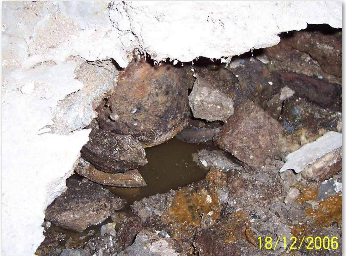
Bild 46: Hohlraum unter der Bodenplatte – Detailansicht zu Bild 45 [Foto: Abwasser-Service Volkner GmbH]
