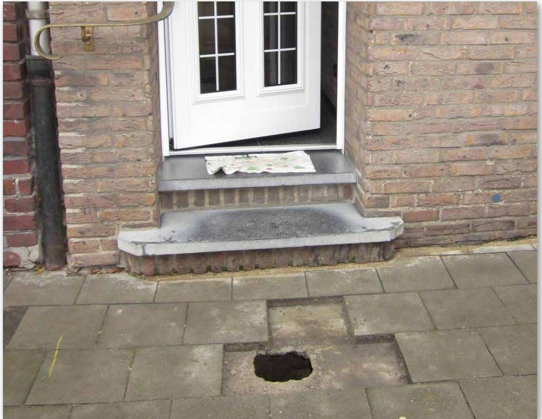
Bild 1: Absackung im Gehwegsbereich mit Hohraumbildung [Foto: Stadt Alsdorf]
