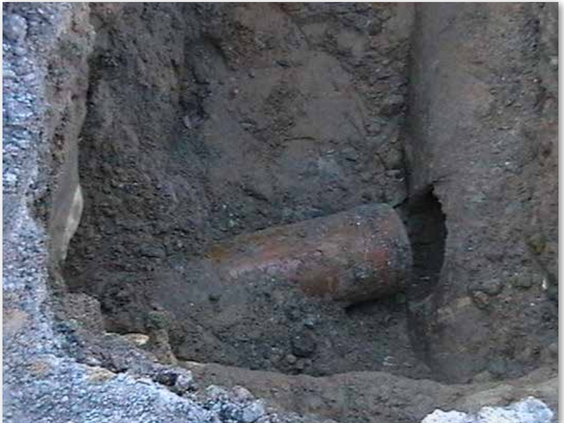
Bild 24: Freigelegte private Abwasserleitung im Bereich der Absackung aus Bild 22 – Anschluss defekt [Foto: Technische Werke Emmerich am Rhein GmbH]
