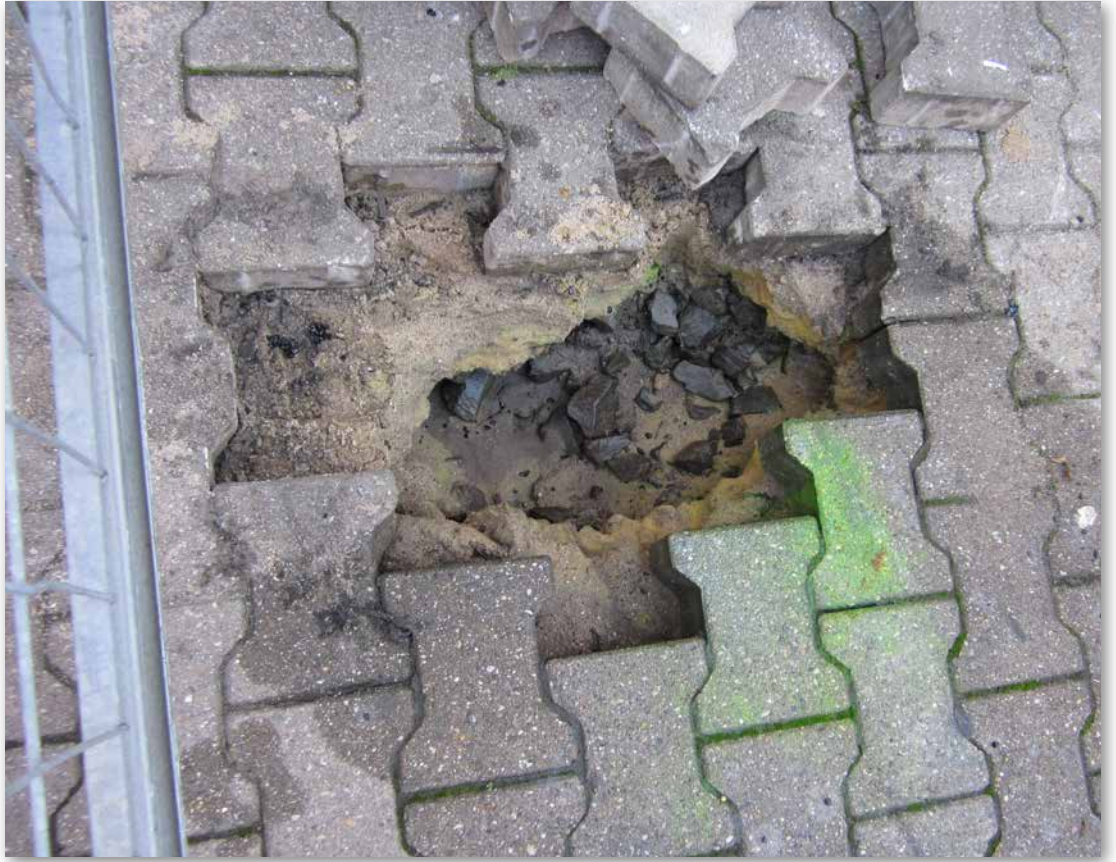
Bild 35: Straßeneinbruch im öffentlichen Verkehrsraum, Beispiel 10 [Foto: GELSENKANAL]
