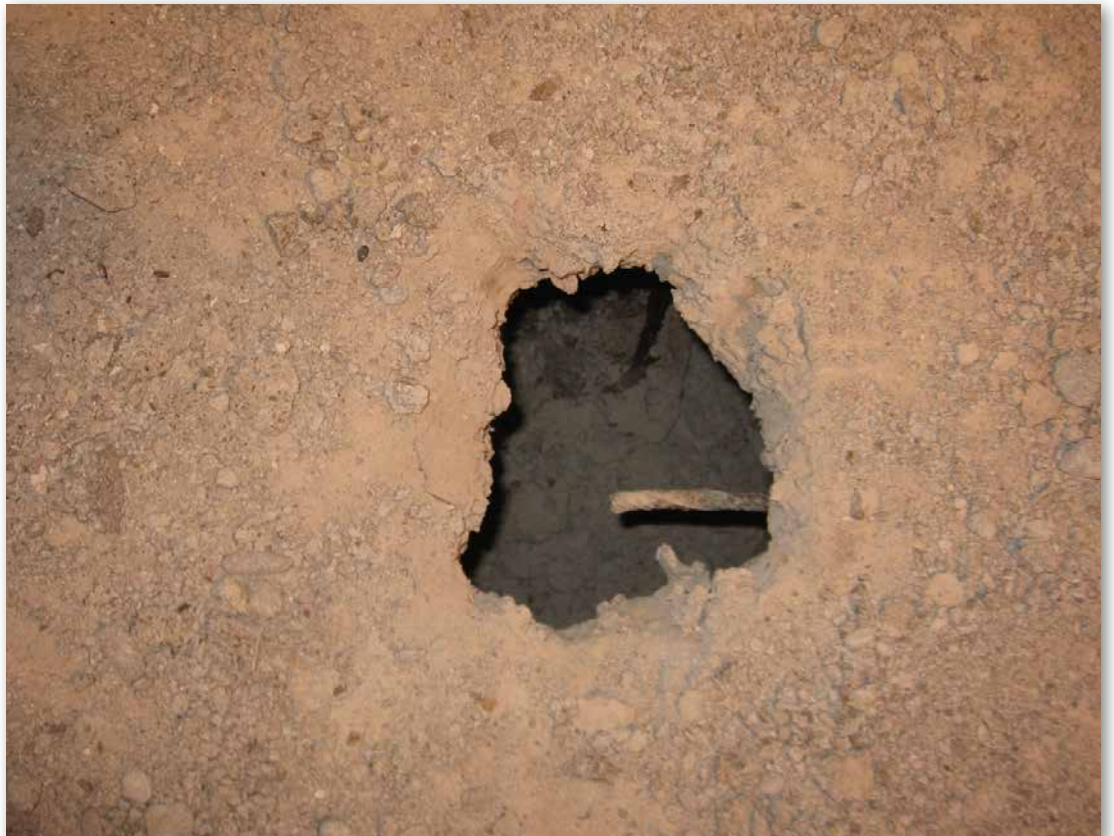
Bild 47: Straßeneinbruch mit unterirdischem Hohlraum im öffentlichen Verkehrsraum [Foto: Abwasser-Service Volkner GmbH]
