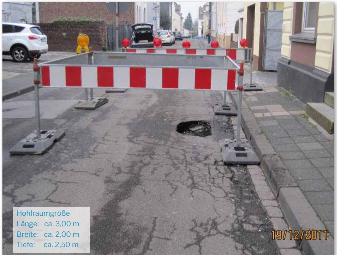
Bild 55: Straßeneinbruch mit unterirdischem Hohlraum in der Goldstraße [Foto: Technische Betriebe Solingen]
