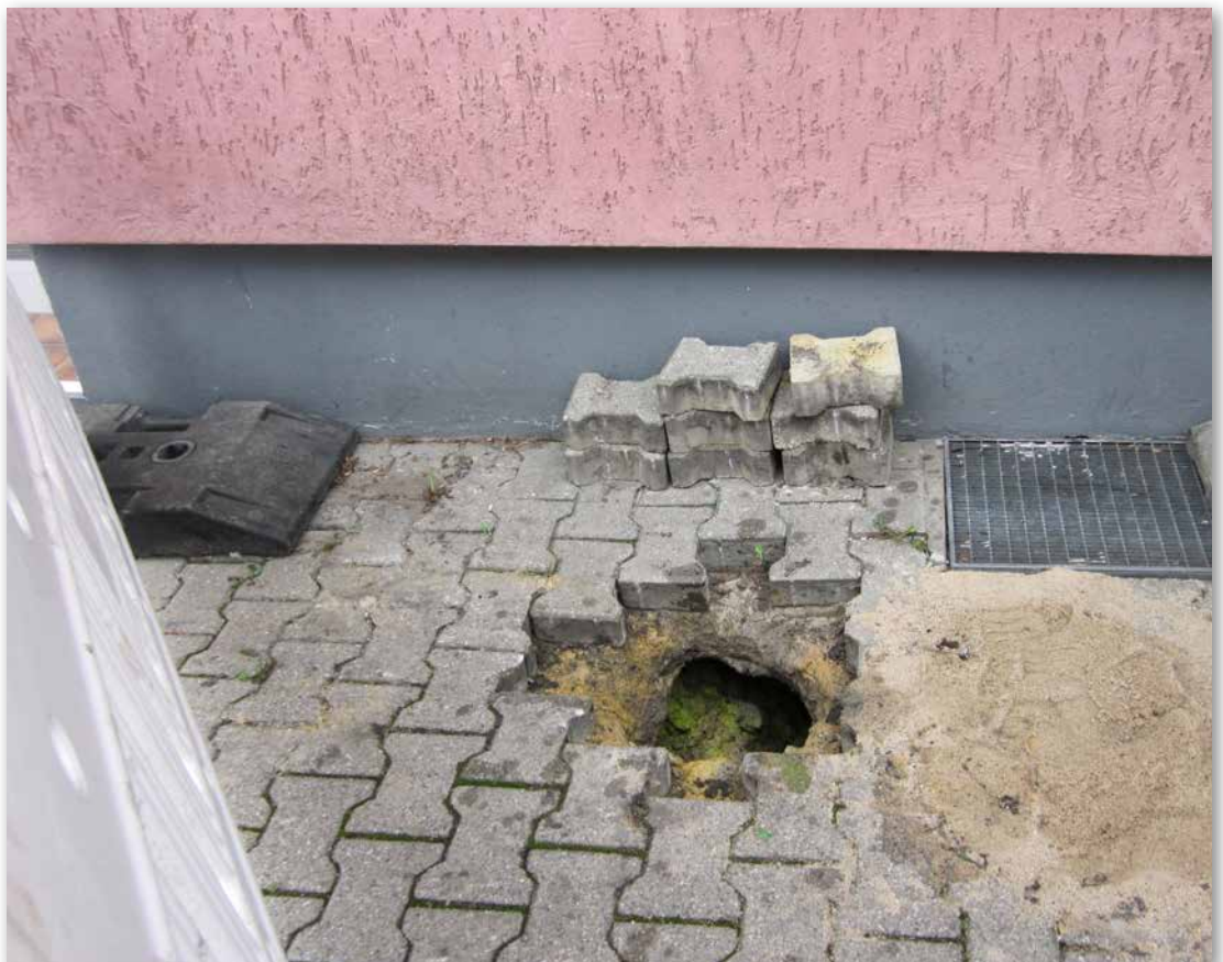
Bild 34: Straßeneinbruch im öffentlichen Verkehrsraum, Beispiel 9 [Foto: GELSENKANAL]
