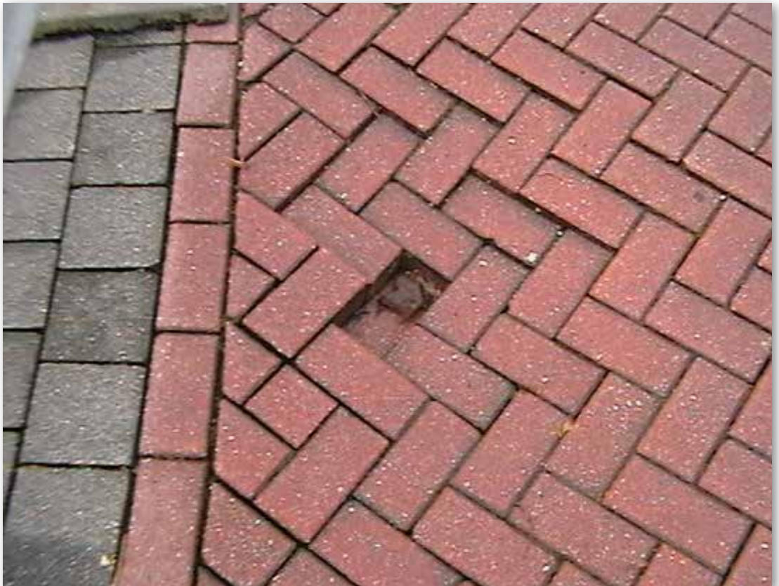
Bild 22: Absackung im Straßenpflaster eines verkehrsberuhigten Bereiches [Foto: Technische Werke Emmerich am Rhein GmbH]
