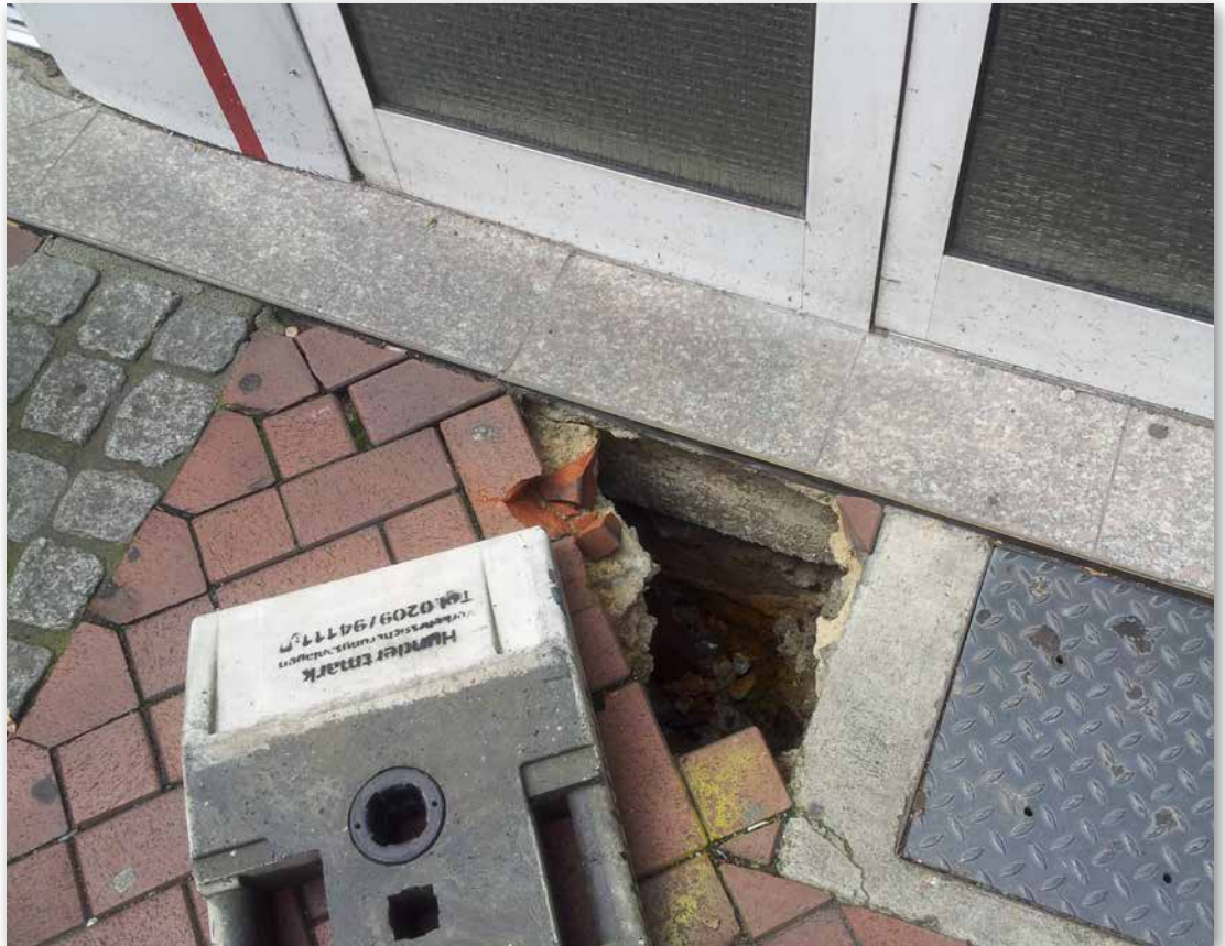
Bild 33: Straßeneinbruch im öffentlichen Verkehrsraum, Beispiel 8 [Foto: GELSENKANAL]
