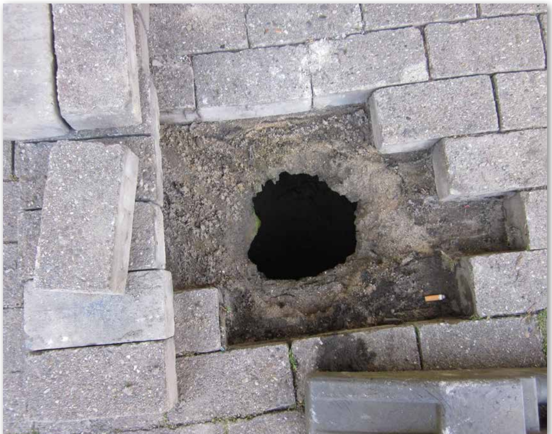
Bild 28: Hohlraum – Detailansicht zu Bild 27 [Foto: GELSENKANAL]
