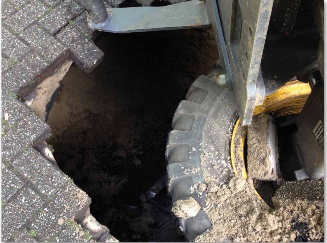
Bild 76: Umgestürzter Bagger infolge eines Tagesbruchs im öffentlichen Verkehrsraum, Ansicht 3 [Foto: Regh Holding GmbH]
