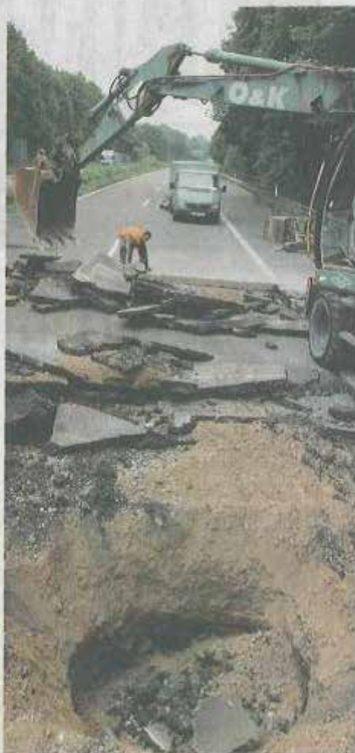
Schon nach Abheben der abgesackten Asphaltdecke tat sich ein tiefes Loch in der Fahrbahn auf, das sich später weiter vergrößerte. Foto: up
