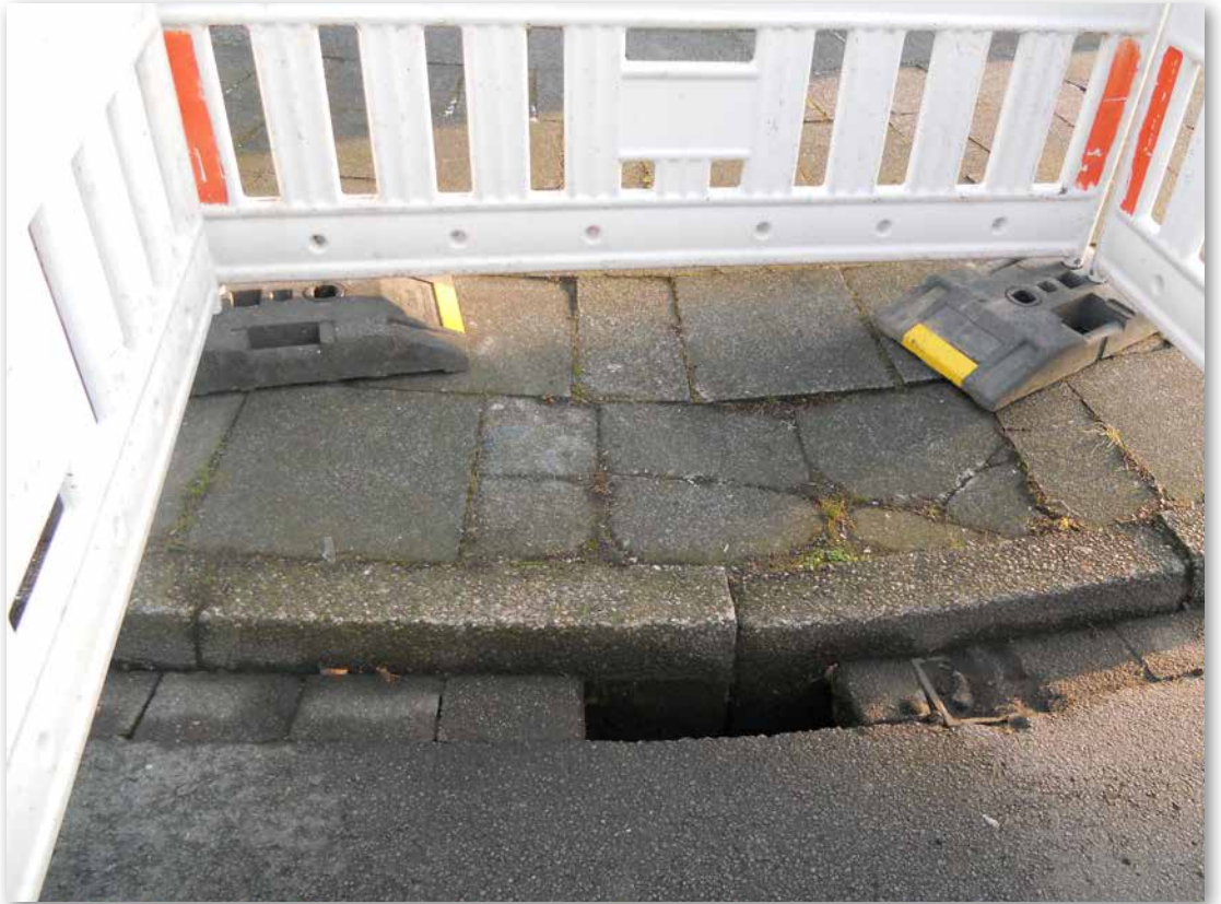
Bild 15: Straßeneinbruch im öffentlichen Verkehrsraum im Bereich des Bordsteins [Foto: Stadt Dortmund]
