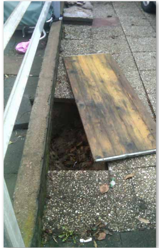
Bild 44: Hohlraum – Detail zu Bild 43 [Fotos: Abwasser-Service Volkner GmbH]
