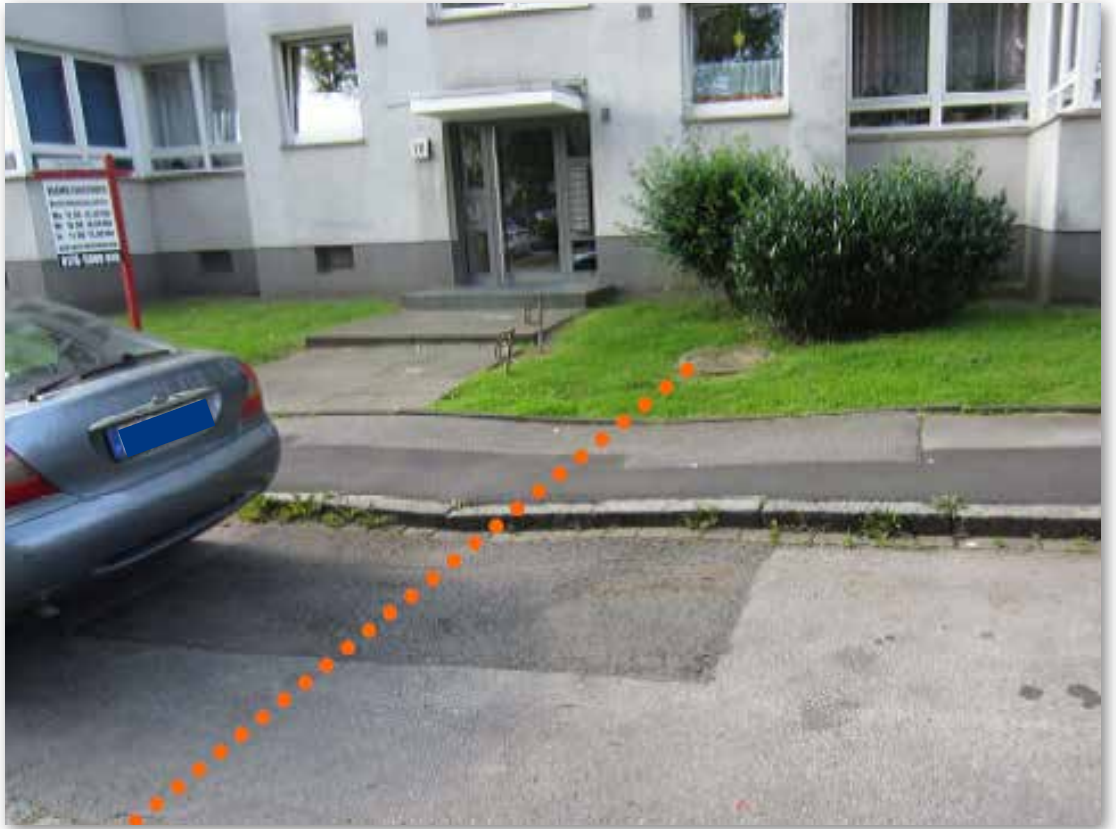
Bild 11: Absackung im Straßen-, Gehweg- und Hofbereich (in orange: Verlauf Anschlussleitung), Beispiel 3 [Foto: Stadt Dortmund]
