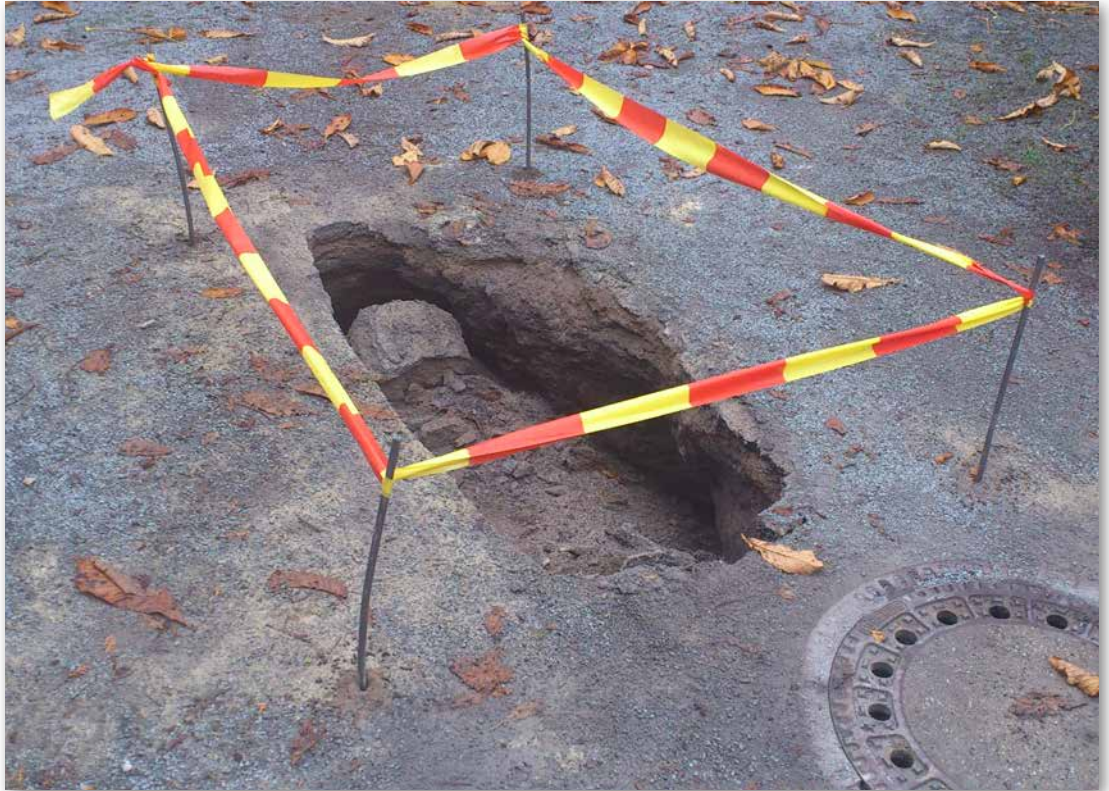
Bild 71: Absackung mit Bodeneinbruch auf einem privaten Grundstück in Castrop-Rauxel [Foto: Lobbe Entsorgung West GmbH & Co KG]
