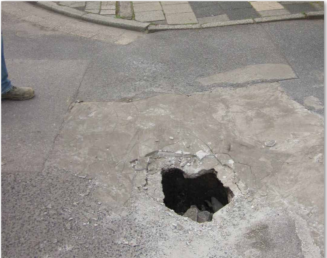
Bild 4: Straßeneinbruch im öffentlichen Verkehrsraum [Foto: Stadt Alsdorf]
