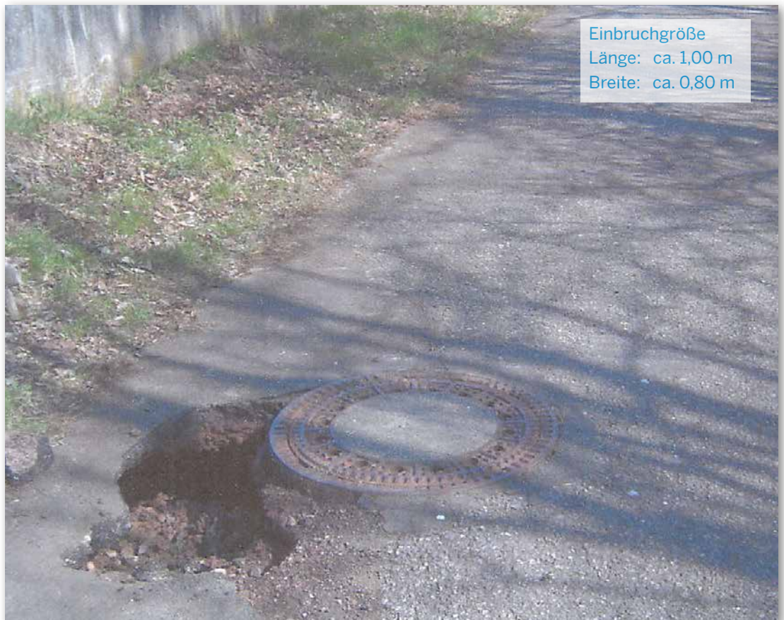
Bild 50: Straßeneinbruch im öffentlichen Verkehrsraum, Beispiel 2 [Foto: SEG Schwerte]
