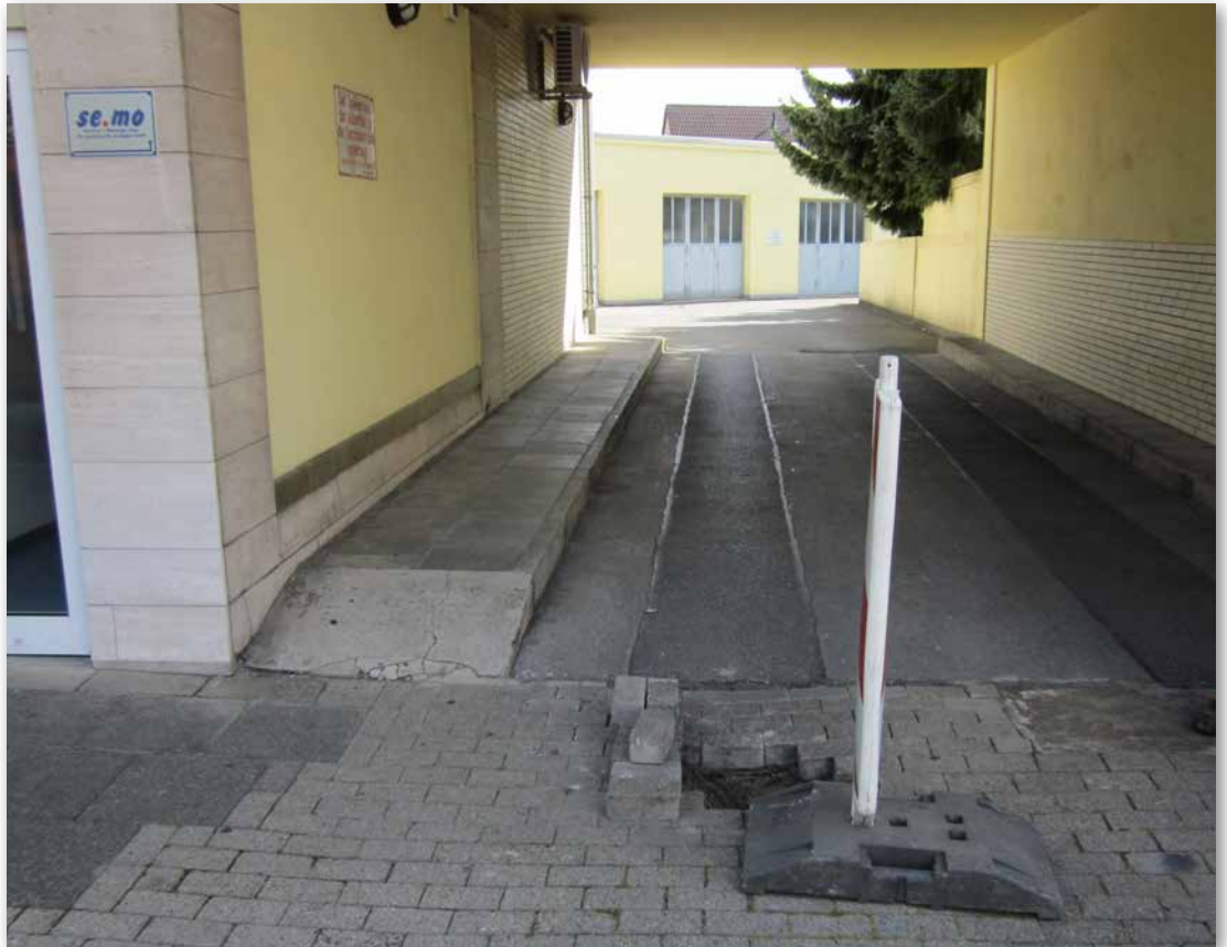
Bild 27: Straßeneinbruch im öffentlichen Verkehrsraum, Beispiel 3 [Foto: GELSENKANAL]
