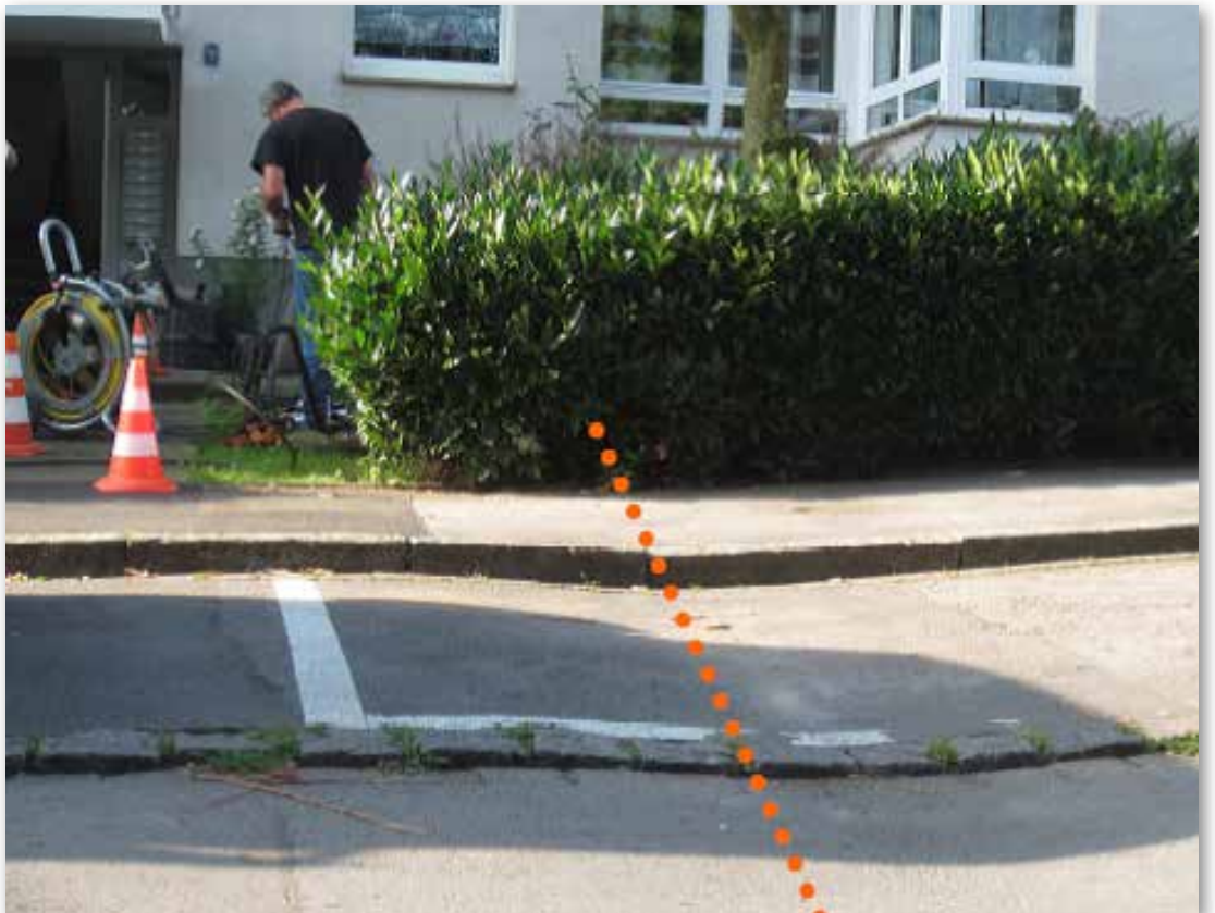
Bild 12: Absackung im Straßen-, Gehweg- und Hofbereich (in orange: Verlauf Anschlussleitung), Beispiel 4 [Foto: Stadt Dortmund]
