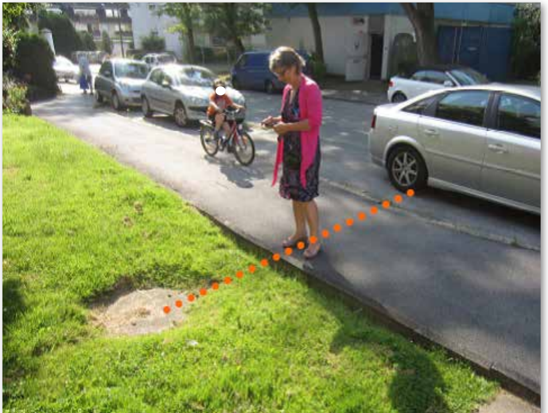
Bild 10: Absackung im Straßen-, Gehweg- und Hofbereich (in orange: Verlauf Anschlussleitung), Beispiel 2 [Foto: Stadt Dortmund]
