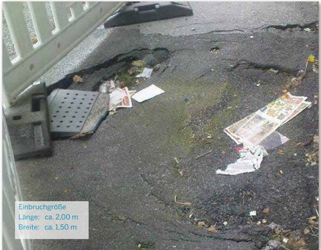
Bild 7: Straßeneinbruch im öffentlichen Verkehrsraum [Foto: Stadt Bochum]
