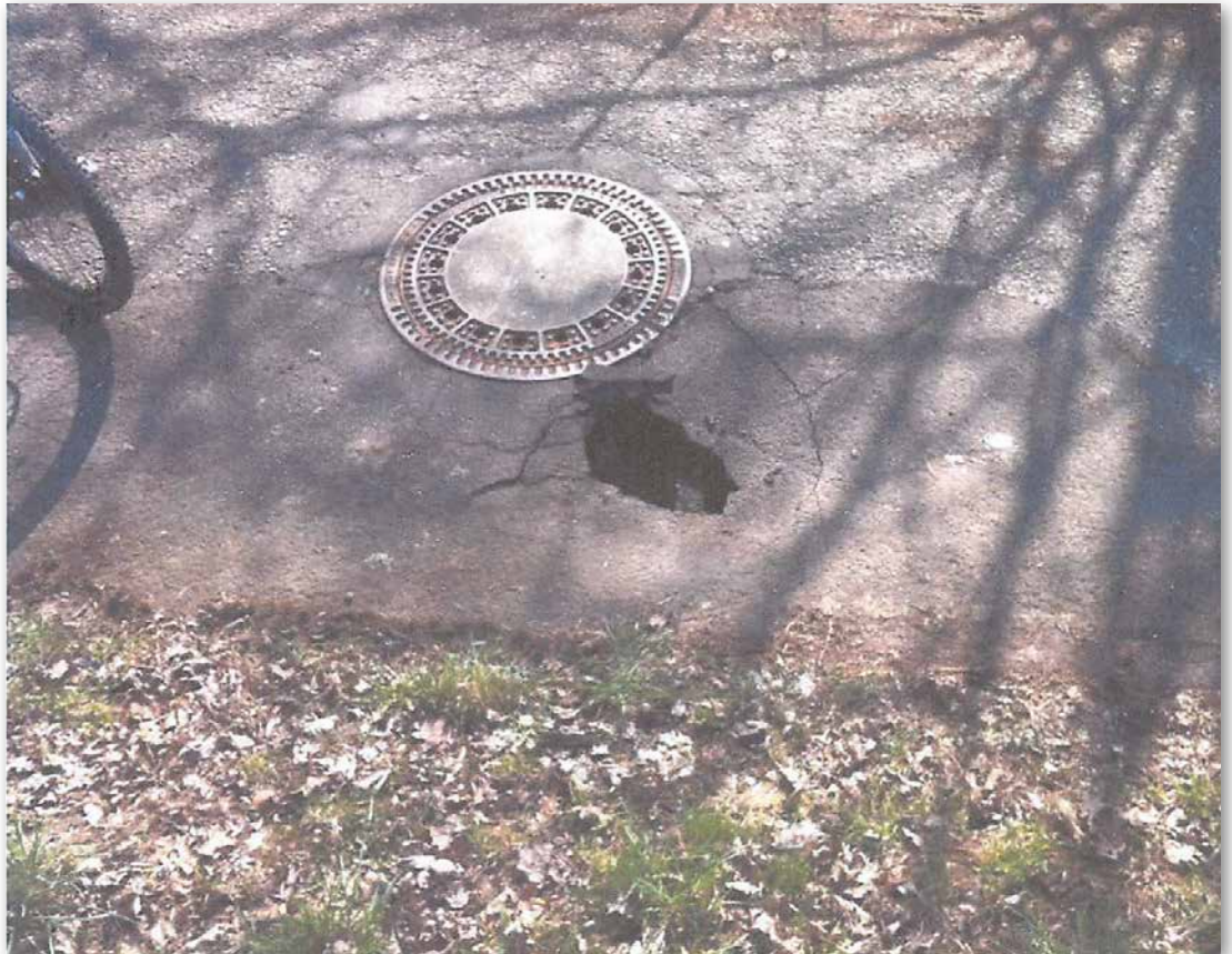
Bild 49: Straßeneinbruch im öffentlichen Verkehrsraum, Beispiel 1 [Foto: SEG Schwerte]
