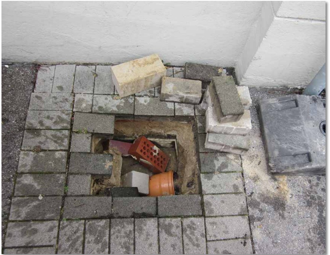
Bild 25: Straßeneinbruch im öffentlichen Verkehrsraum, Beispiel 1 [Foto: GELSENKANAL]
