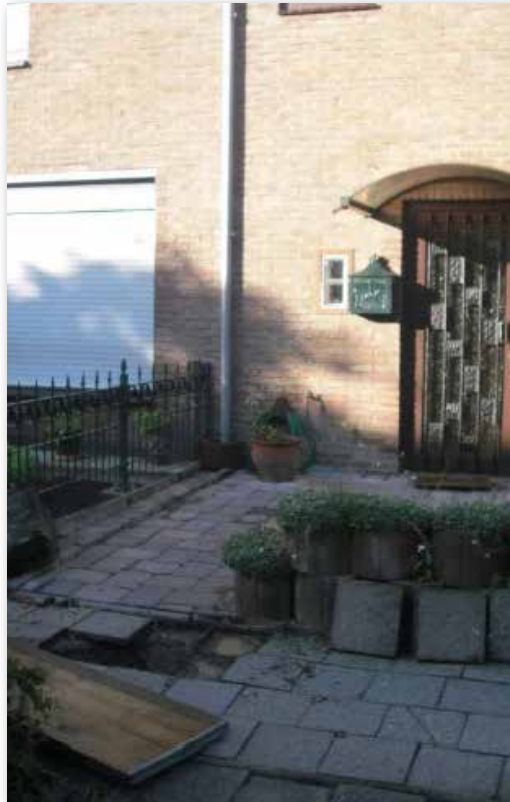
Bild 17: Absackung im Eingangsbereich [Foto: Technische Werke Emmerich am Rhein GmbH]
