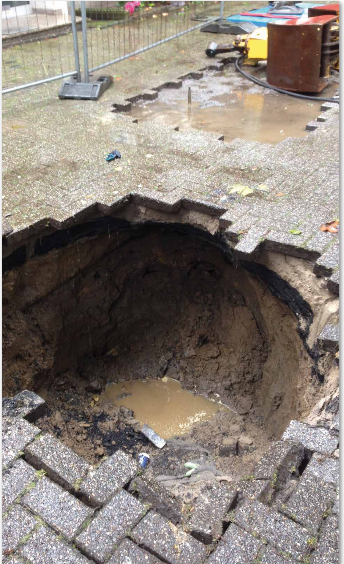
Bild 78: Tagesbruch im öffentlichen Verkehrsraum im Detail [Foto: Regh Holding GmbH]
