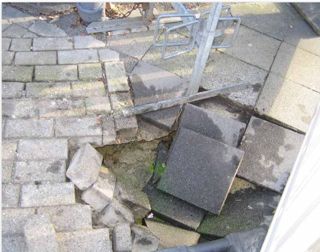
Bild 31: Straßeneinbruch im öffentlichen Verkehrsraum, Beispiel 6 [Foto: GELSENKANAL]
