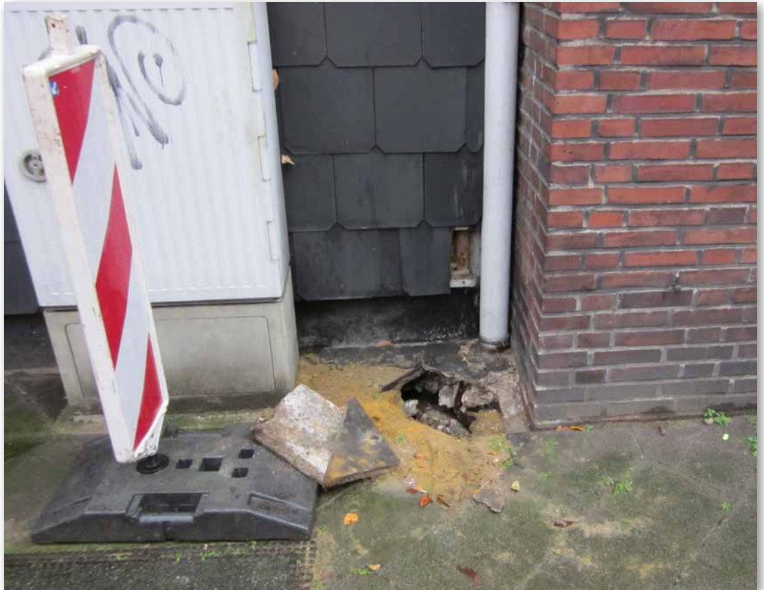
Bild 37: Straßeneinbruch im öffentlichen Verkehrsraum, Beispiel 12 [Foto: GELSENKANAL]
