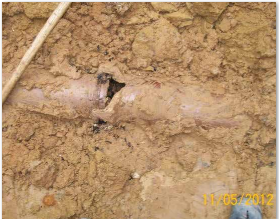
Bild 14: Detailansicht zu Bild 13 – freigelegte defekte Hausanschlussleitung [Foto: Stadt Dortmund]
