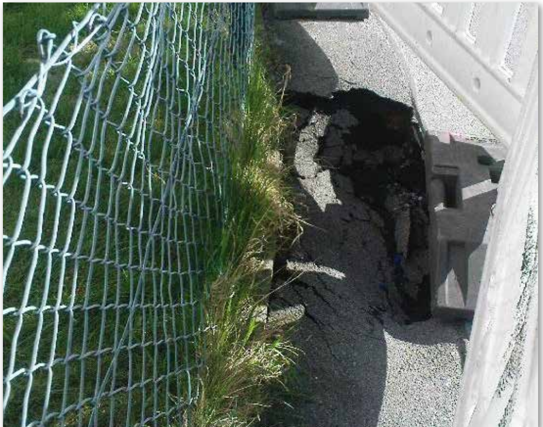
Bild 8: Straßeneinbruch im öffentlichen Verkehrsraum [Foto: Stadt Bochum]
