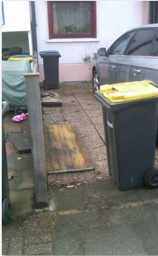
Bild 43: Absackung auf PKW-Stellfläche [Fotos: Abwasser-Service Volkner GmbH]
