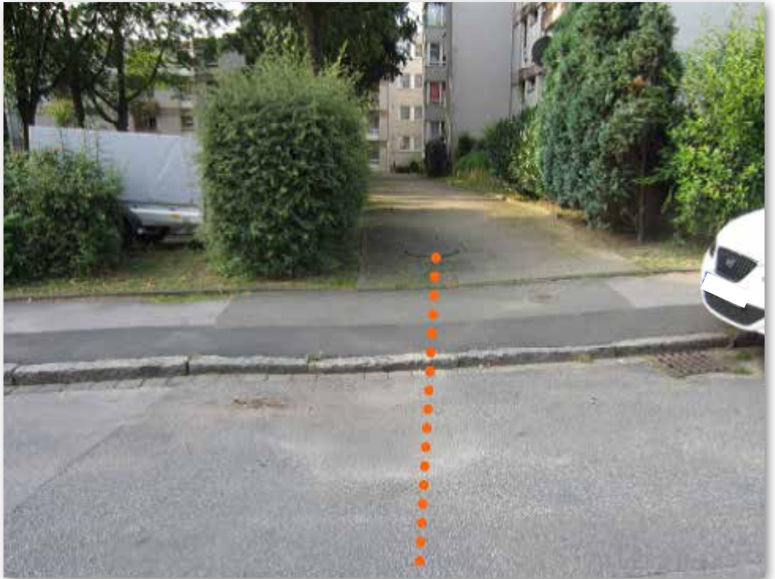
Bild 9: Absackung im Straßen-, Gehweg- und Hofbereich (in orange: Verlauf Anschlussleitung), Beispiel 1 [Foto: Stadt Dortmund]
