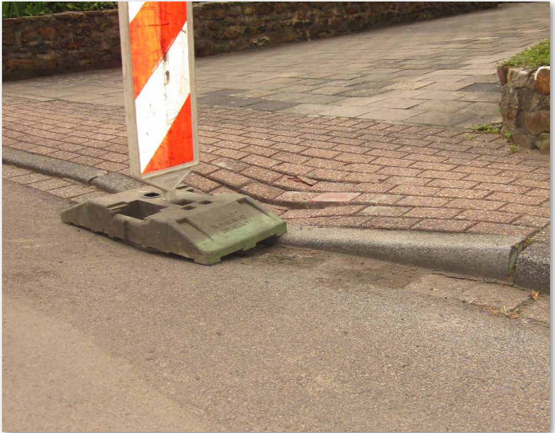
Bild 3: Absackung im Gehwegsbereich [Foto: Stadt Alsdorf]
