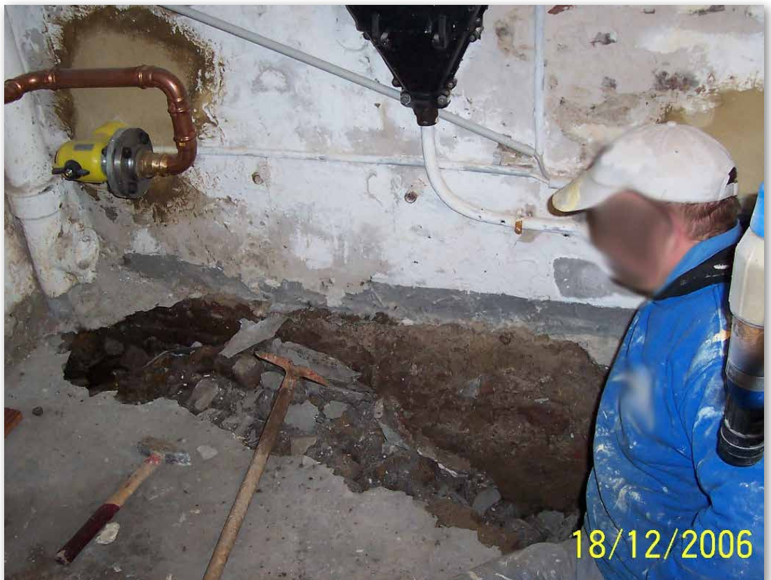
Bild 45: Bodeneinbruch im Keller eines Wohnhauses verursacht durch defekte private Abwasserleitung [Foto: Abwasser-Service Volkner GmbH]
