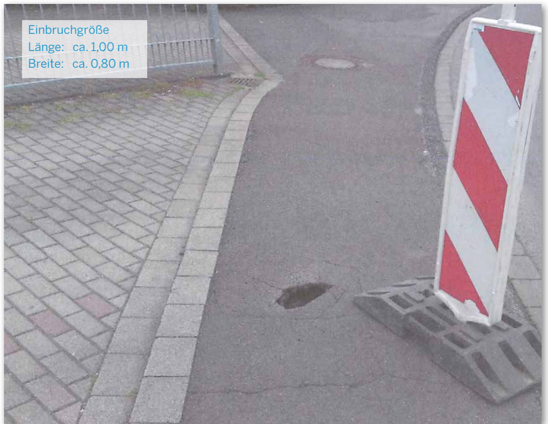
Bild 51: Straßeneinbruch im öffentlichen Verkehrsraum, Beispiel 3 [Foto: SEG Schwerte]
