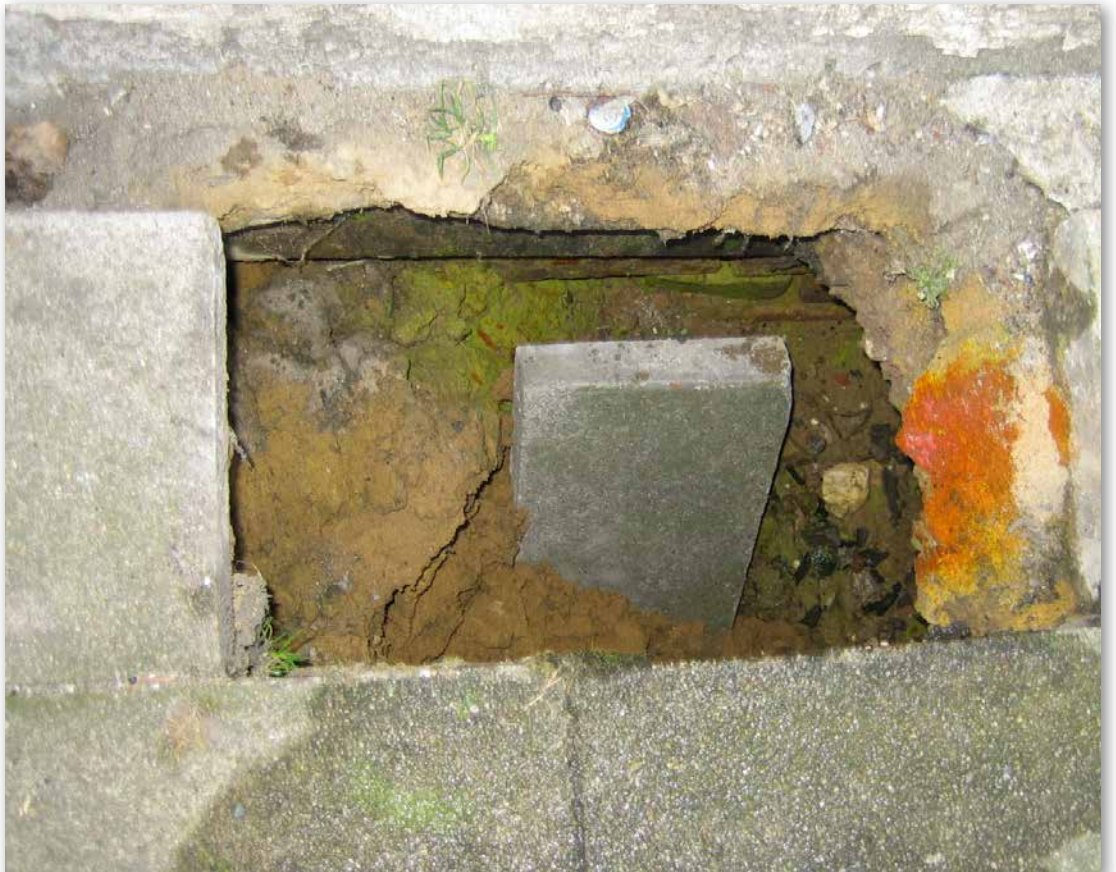
Bild 30: Straßeneinbruch im öffentlichen Verkehrsraum, Beispiel 5 [Foto: GELSENKANAL]
