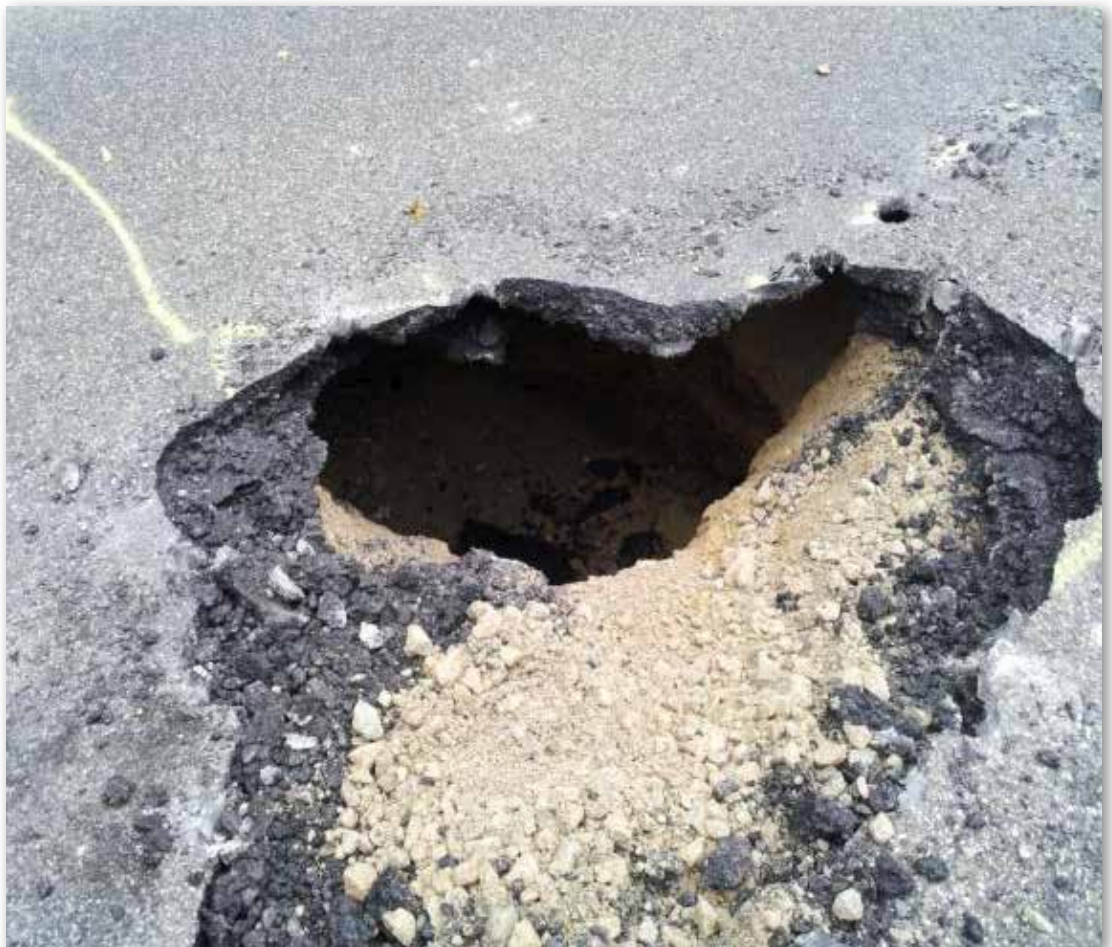
Bild 60: Straßeneinbruch mit unterirdischem Hohlraum in der Viehbachtalstraße [Foto: Technische Betriebe Solingen]
