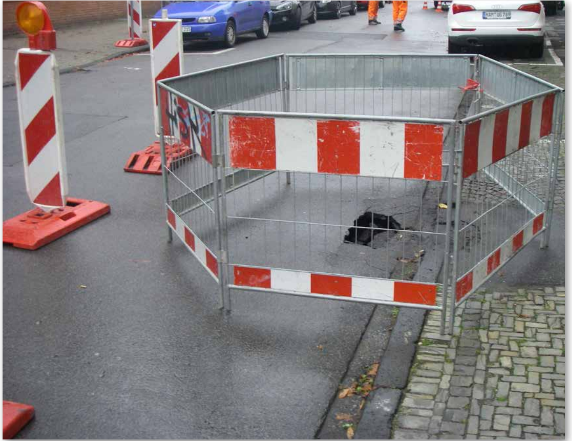
Bild 42: Straßeneinbruch im öffentlichen Verkehrsraum, Foto 3 [Foto: Stadt Hamm]
