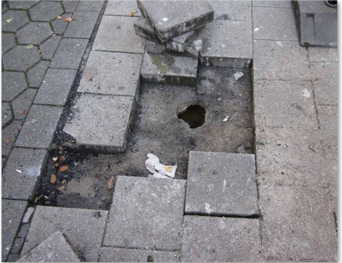
Bild 29: Straßeneinbruch im öffentlichen Verkehrsraum, Beispiel 4 [Foto: GELSENKANAL]
