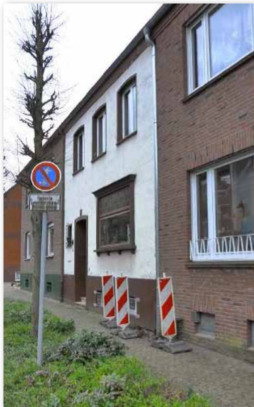
Bild 19: Absackung im Gehweg [Foto: Technische Werke Emmerich am Rhein GmbH]
