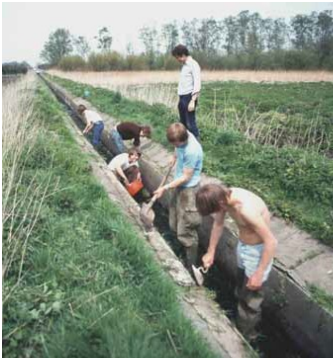
Abbildung 81: 1976 wurde der noch offene Hauptzuleiter mühsam repariert (die Arbeitsgemeinschaft für Ornithologie und Naturschutz AGON bei der Arbeit) Foto: Archiv Biol. Station Rieselfelder Münster
