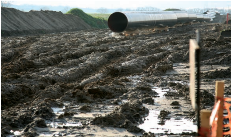
Der Boden guckt in die Röhre: Verdichtungsschäden beim Rohrleitungsbau.
