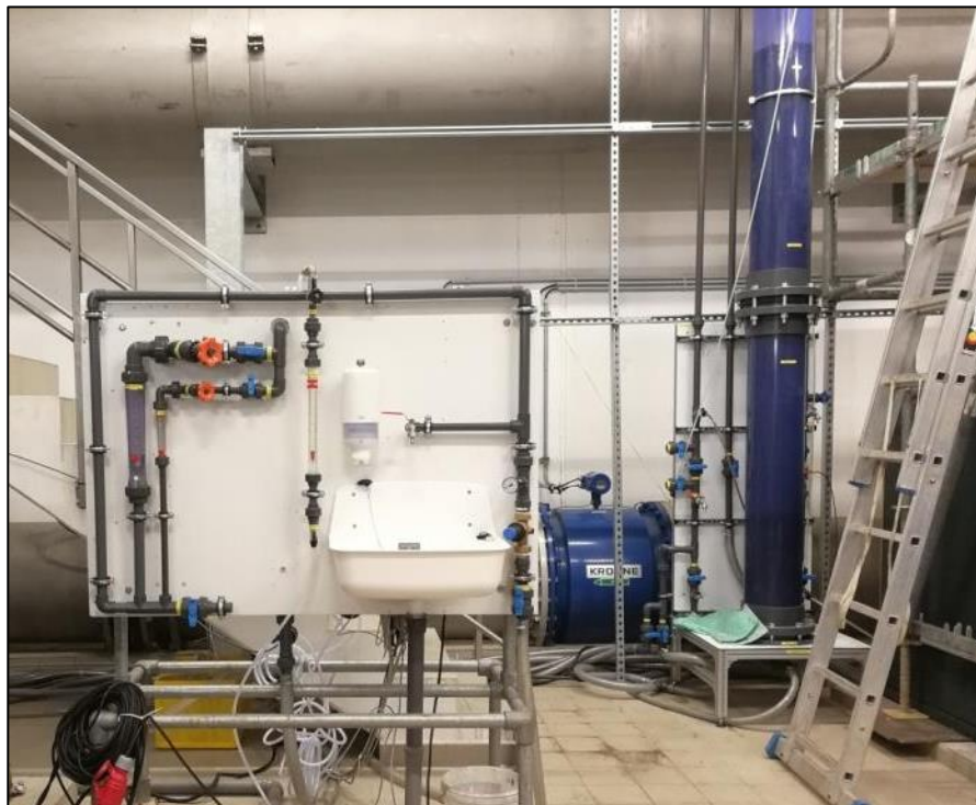
Abbildung 10: Mess- und Steuereinrichtung für die Filterspülung
