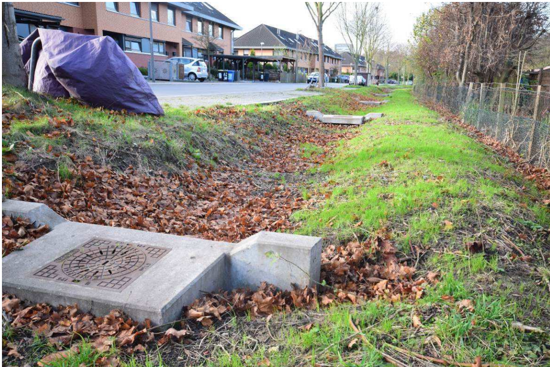
Abbildung 74: Erosion der Muldenböschung an Überlaufelement
