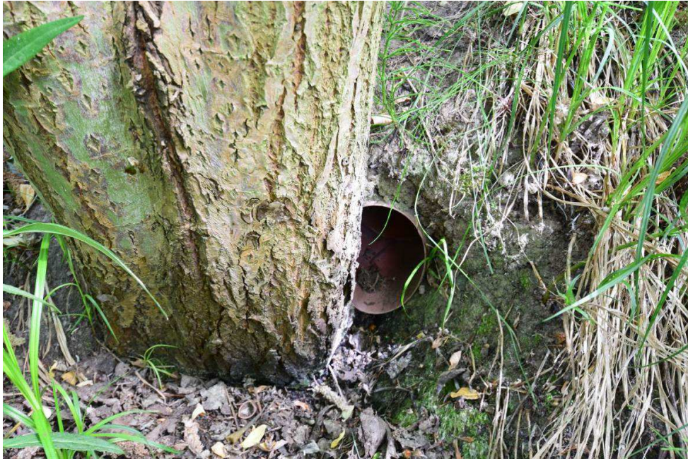
Abbildung 92 Aufwuchs von Gehölzen
