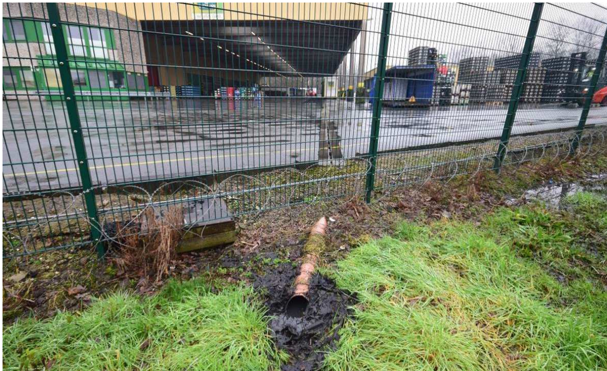
Abbildung 64: Freigelegter, teilweise zugesetzter Grundleitungseinlauf
