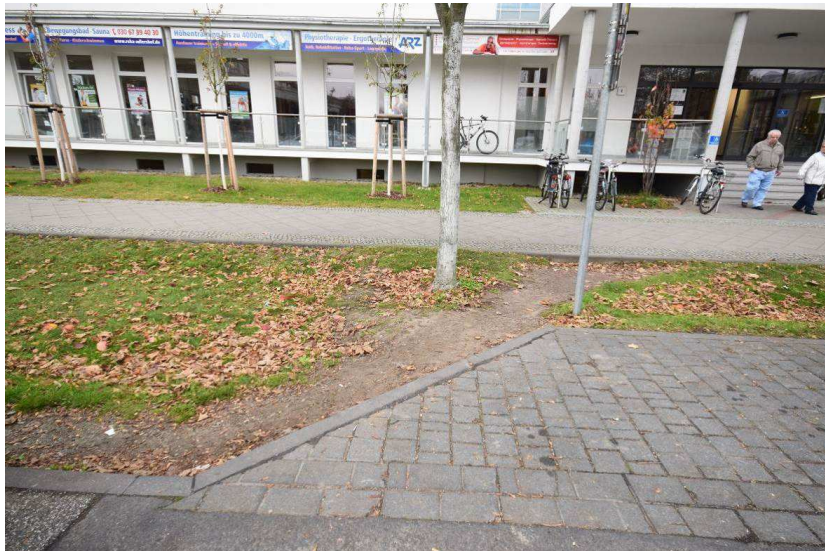
Abbildung 86: Trittshaden straßenbegleitende Mulde vor Ärztehaus, Anlage 7
