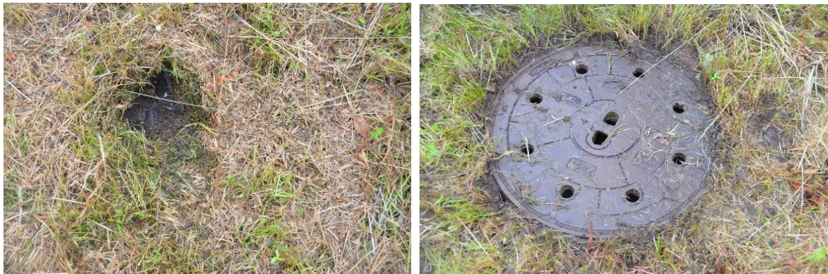
Abbildung 39: Mit Gras zugewachsene Schachtabdeckung eines Drosselschachts im Bereich der Mulden
