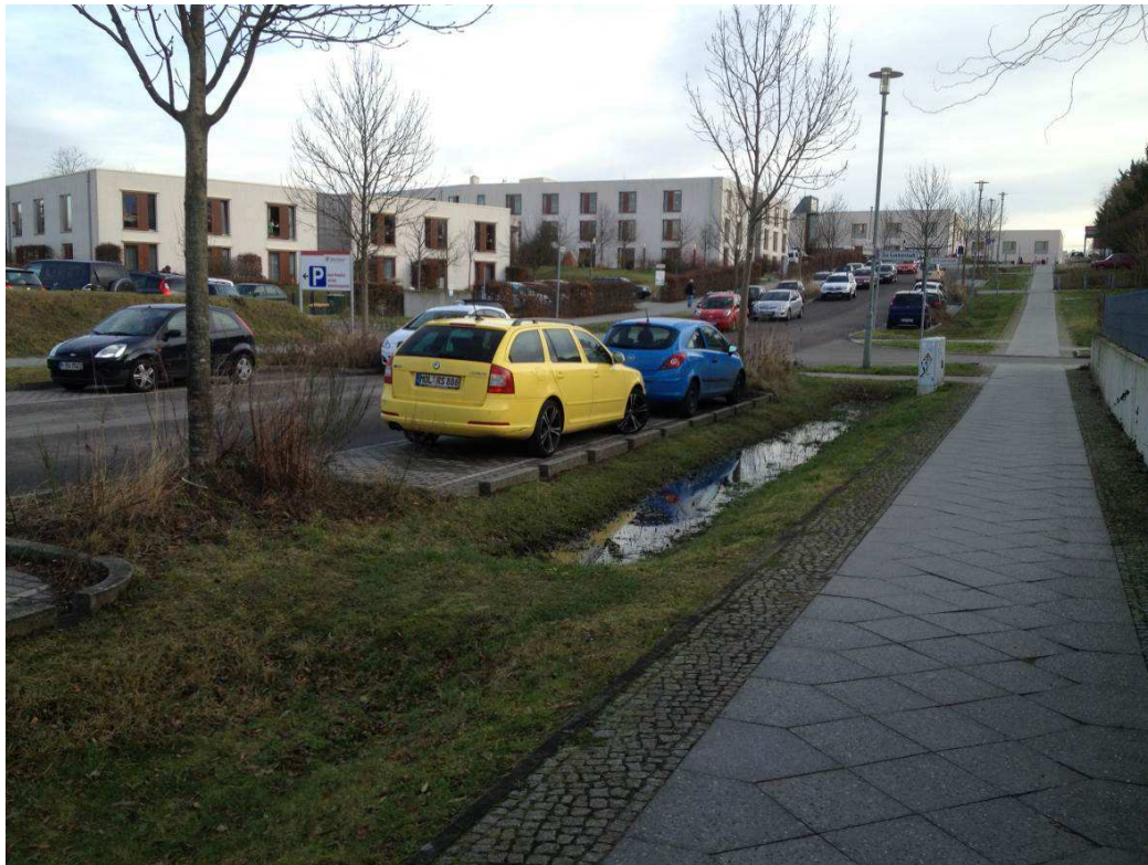
Abbildung 67: hydraulisch überlastete Mulde im Tiefpunkt, Vegetationsschädigung in Folge Eintrag von Feinstoffe und zu häufigem Überstau zieht Infiltrationsstörung nach sich, Anlage 5
