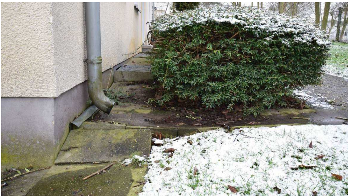
Abbildung 52: Unterspülte offene Rinne mit Setzungsschaden 2/3 Rinnenelement und geänderter Abflussrichtung
