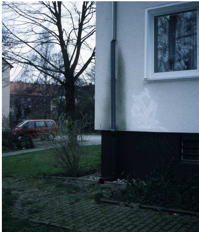
Abbildung 50: Vernässte Gebäudewand durch abgerutschtes Fallrohr
