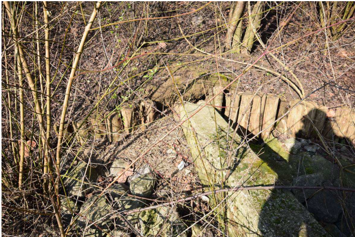
Abbildung 75: Verwitterte Böschungssicherung aus Holz an Überlauf
