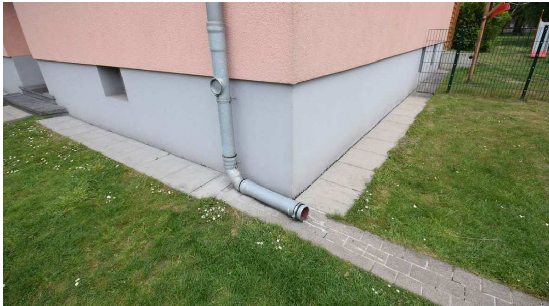
Abbildung 55: An Rinne befestigtes Rohrendstück
