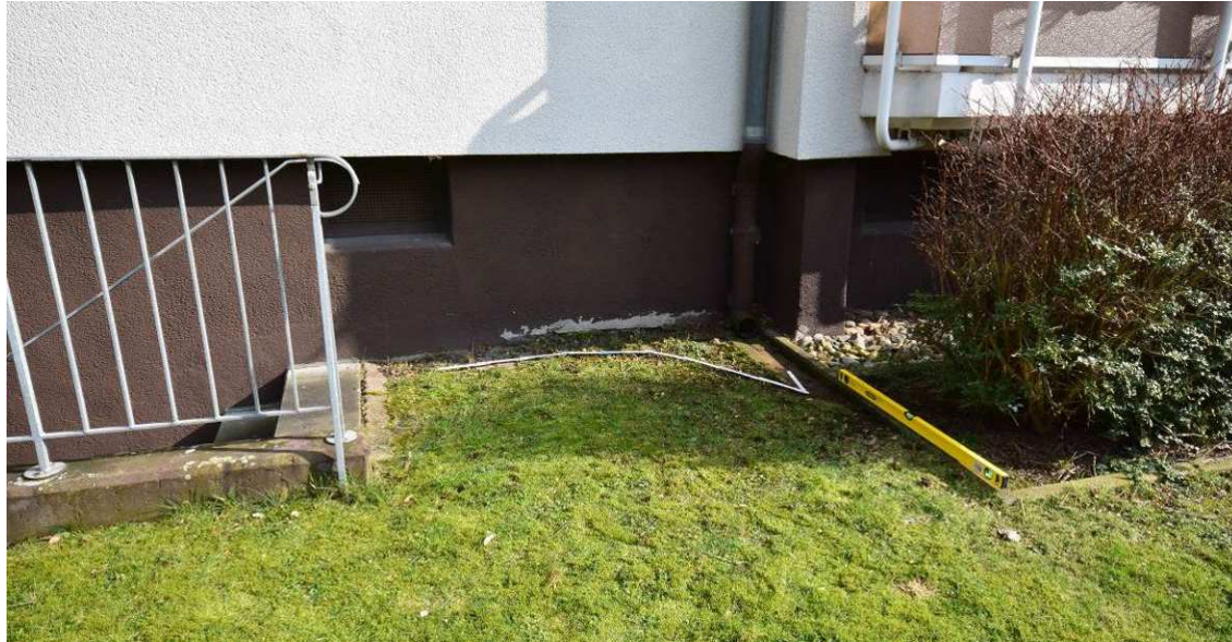
Abbildung 56: Veränderter Fließweg auf abgesackter Pflasterfläche vor Kellertreppe
