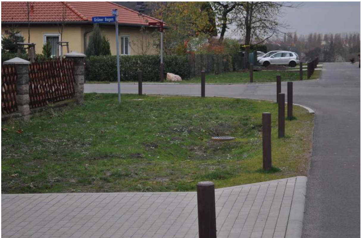
Abbildung 77: Muldenüberlauf direkt in Drosselschacht, kommuniziert mit Rigole. Drosselablauf in Ablauf des Schachtes (oben). Muldenüberlauf, etwas zu flach montiert (unten)
