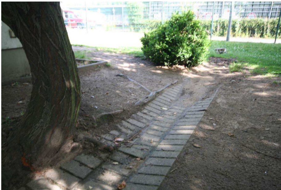
Abbildung 59: Rinne und Muldeneinlaufbereich mit Sedimentablagerungen
